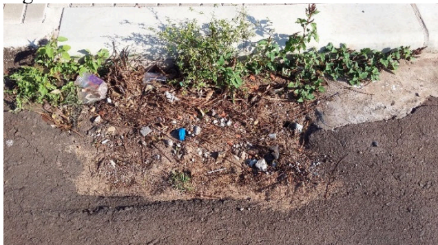
Figura 2 – Boca de lobo no bairro Santa Felicidade entupido por lixo e resíduos
