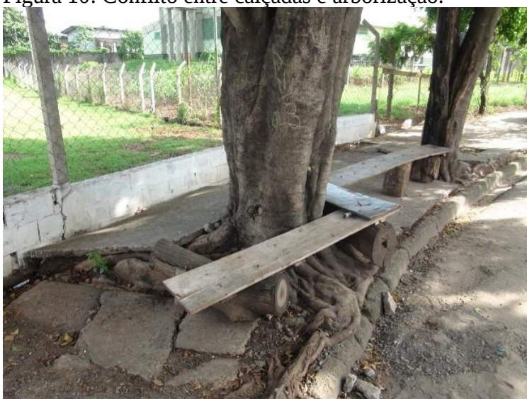
Figura 10: Conflito entre calçadas e arborização.
