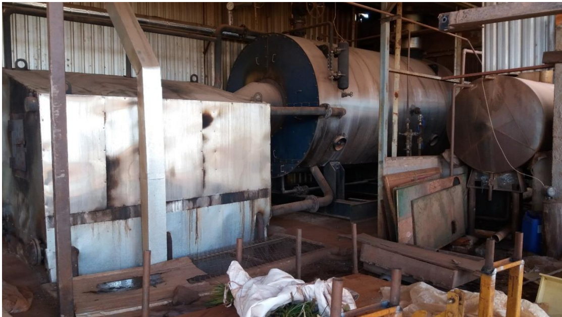
Figura 13: Vista lateral da caldeira.
