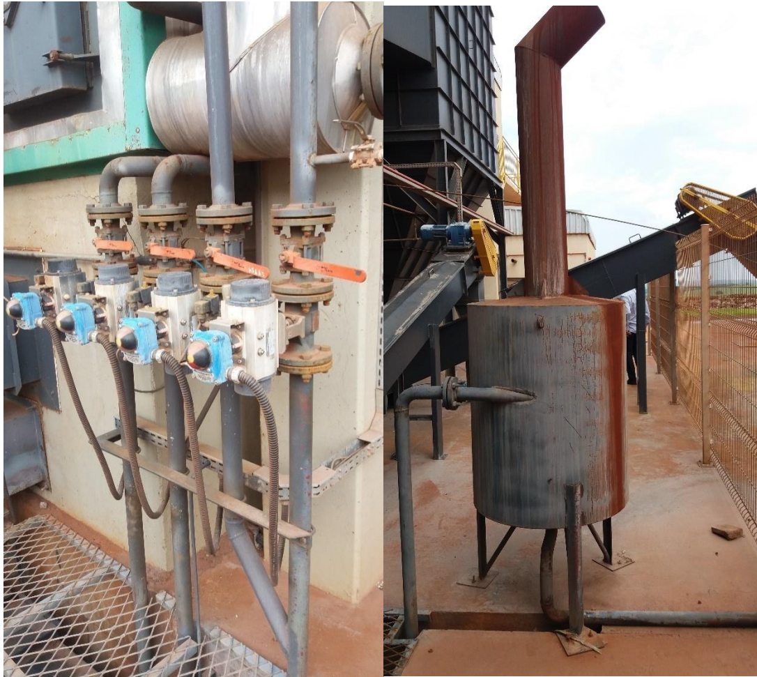
Figura 17: Equipamento para descarga de fundo.
