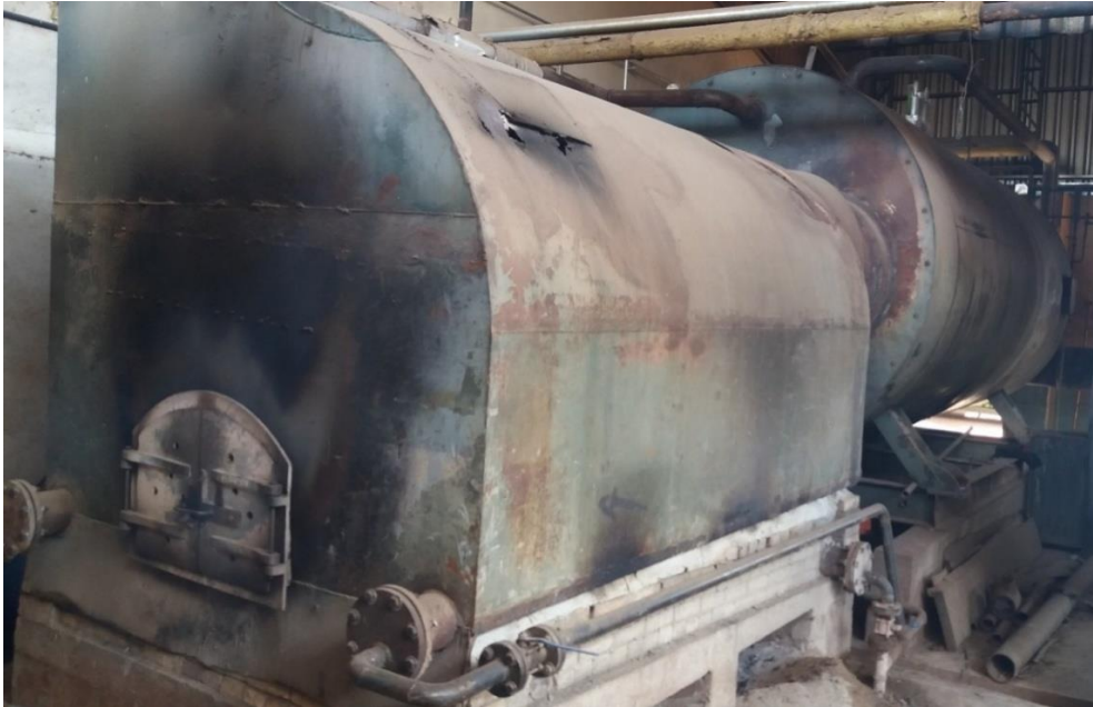
Figura 7: Vista frontal da caldeira 1
