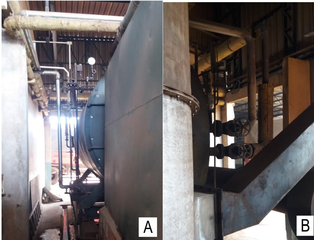
Figura 9: Dispositivos de segurança da caldeira 1 - Manômetro (A) e Válvula de segurança (B)
