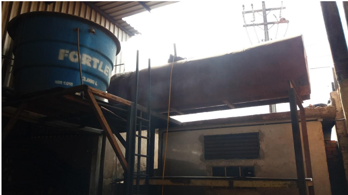
Figura 10: Reservatório de água.
