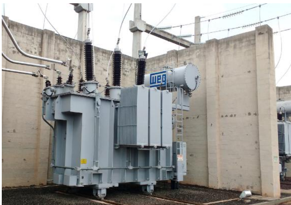
Figura 3.3 - Transformador de potência instalado em subestação
