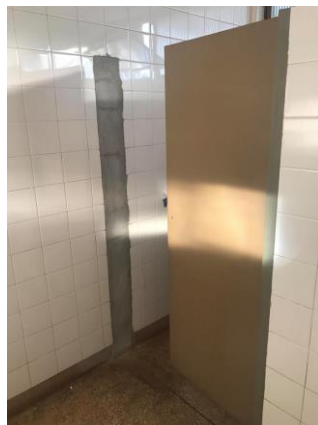
Figura 23: Sanitário sem acessibilidade da rodoviária de Ampére
