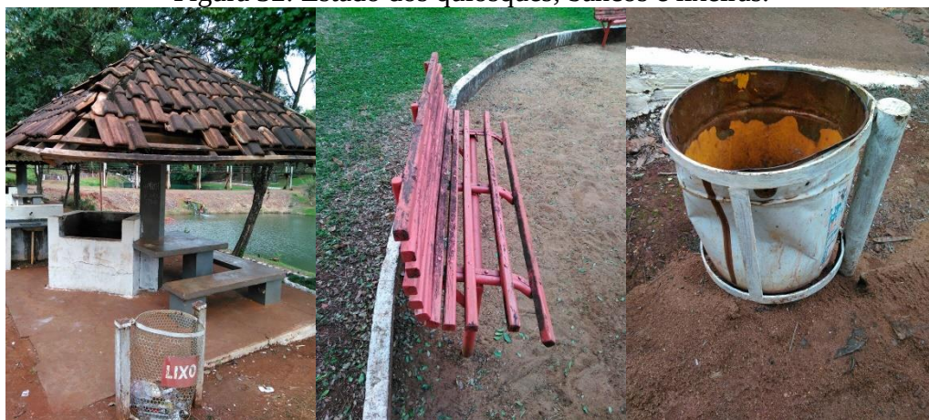
Figura 32: Estado dos quiosques, bancos e lixeiras.
