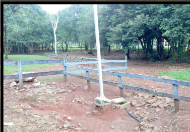
Ponto de erosão
