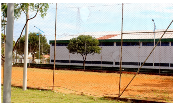
Figura 24 – Grade danificada na quadra externa
