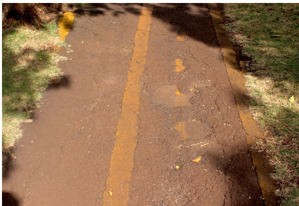
Figura 25 – Pista de caminhada apresentado buracos
