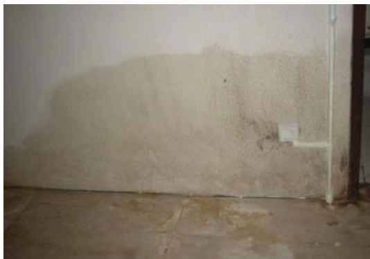
Figura 7: Manchas de infiltração na parede.
