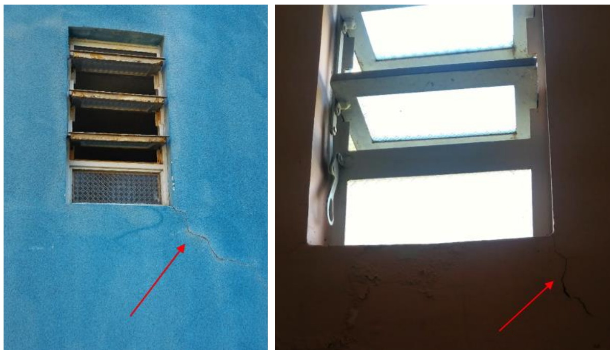
Figura 16: Fissuras com origem nas vertices das aberturas.
