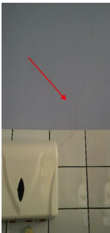
Figura 15: Fissura vertical na parede.
