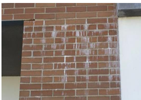
Figura 5: Eflorescência do cimento.
