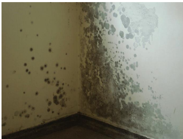
Figura 2: Parede de alvenaria com bolor e mofo.
