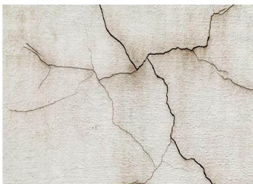
Figura 6: Fissuras e trincas.
