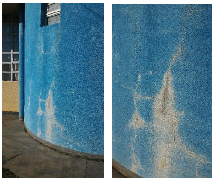
Figura 13: Fissuras parede externa.
