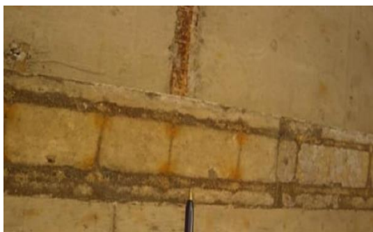
Figura 3: Corrosão da armadura em alvenaria.
