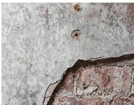
Figura 4: Descolamento do revestimento.
