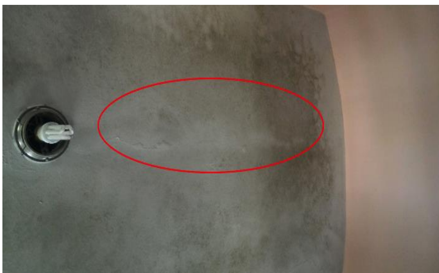
Figura 11: Bolor e infiltração na laje do sanitário.
