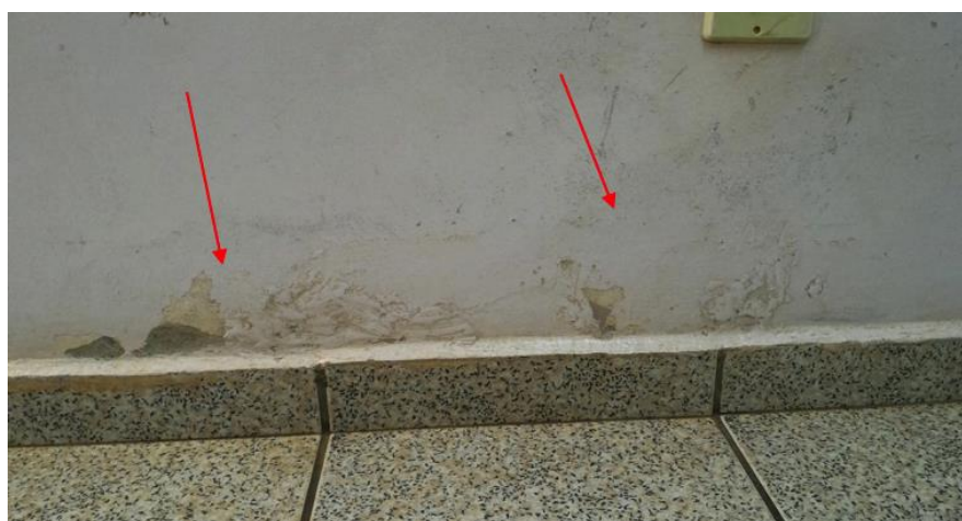
Figura 17: Descolamento do revestimento.
