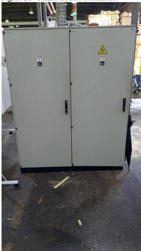
Figura 20 - PAINEL ELÉTRICO ATUALMENTE
