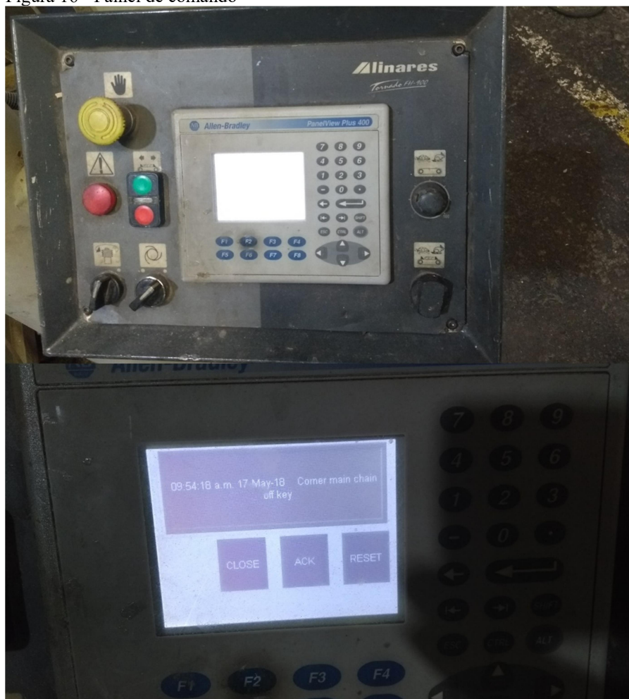
Figura 16 - Painel de comando
