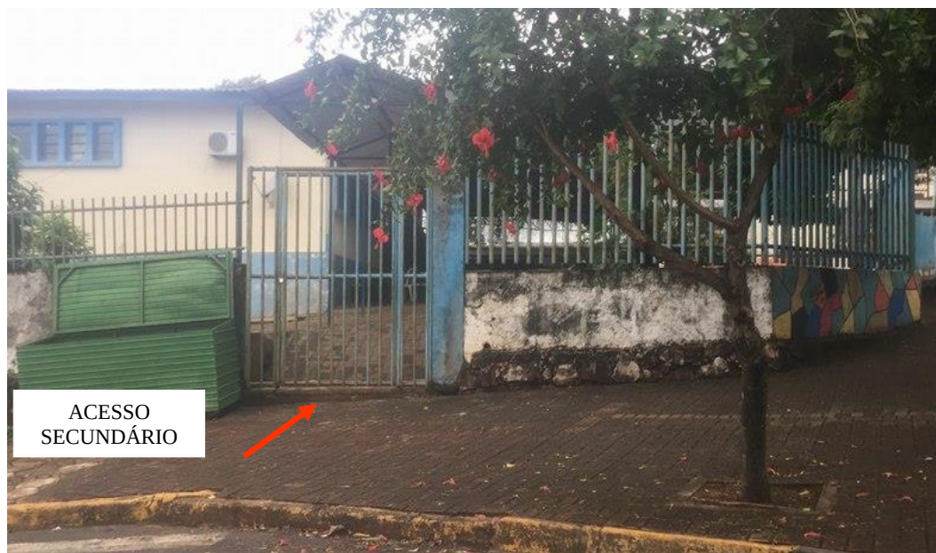
Figura 82: Falta de guia rebaixada e de vaga para deficientes no acesso ao colégio.
