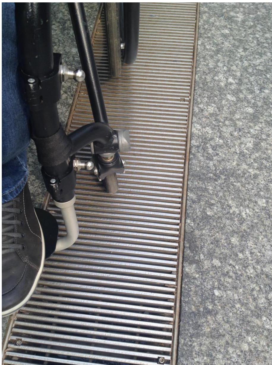
Figura 94: Grelha de escoamento pluvial
