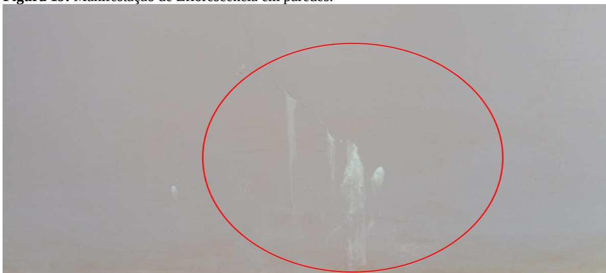
Figura 19: Manifestação de Eflorescência em paredes.
