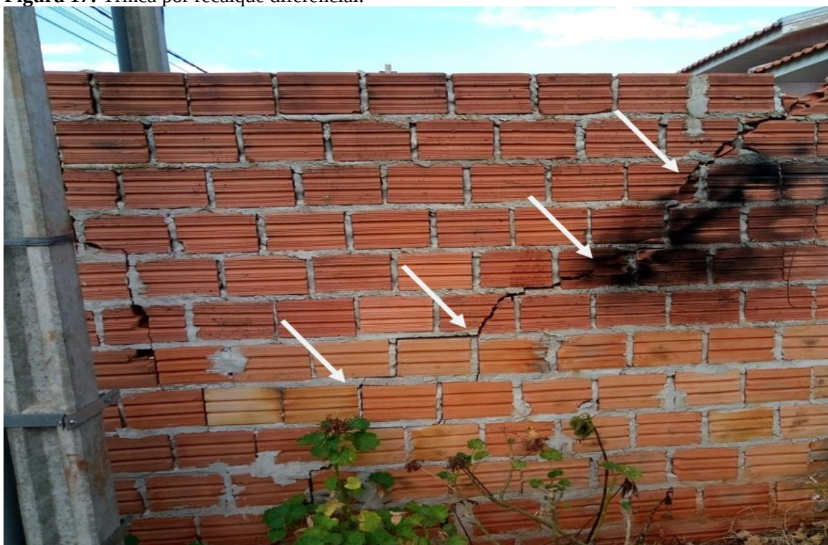
Figura 17: Trinca por recalque diferencial.
