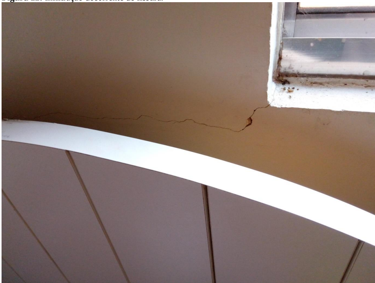
Figura 22: Infiltração decorrente de fissura.
