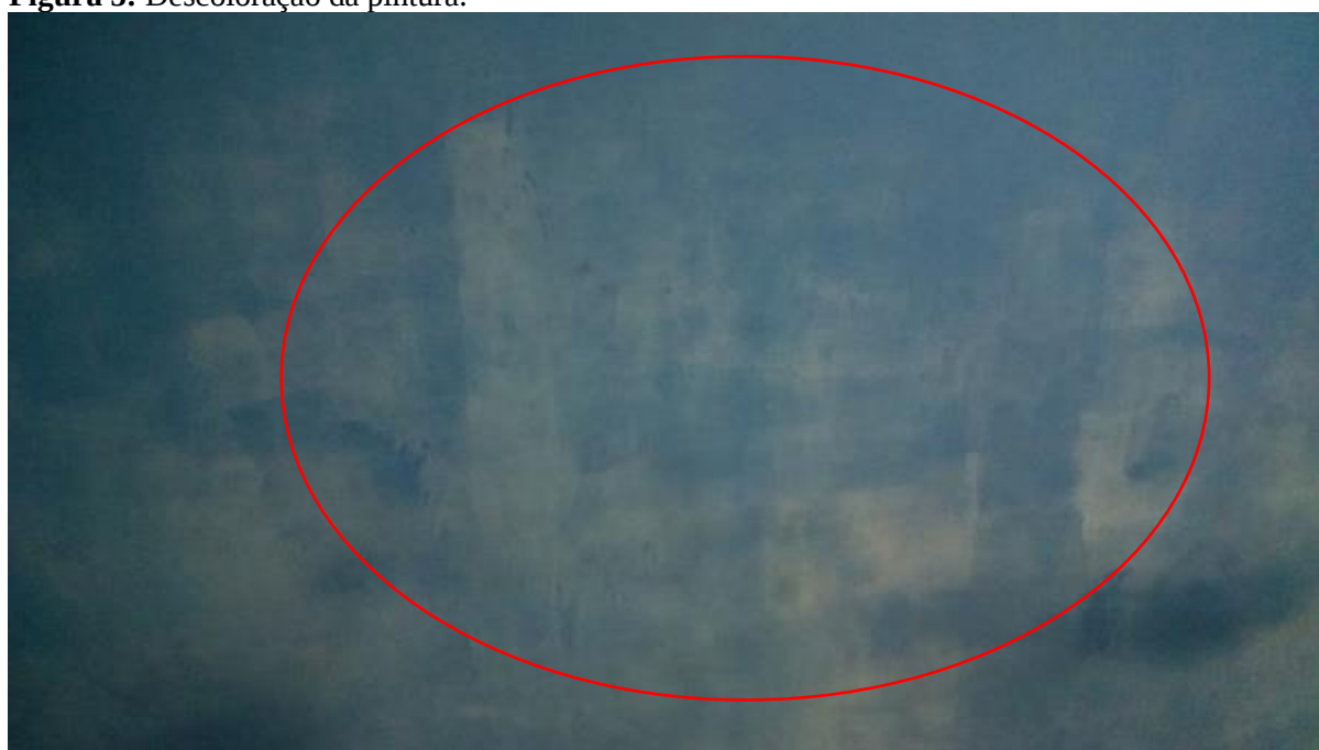
Figura 5: Descoloração da pintura.
