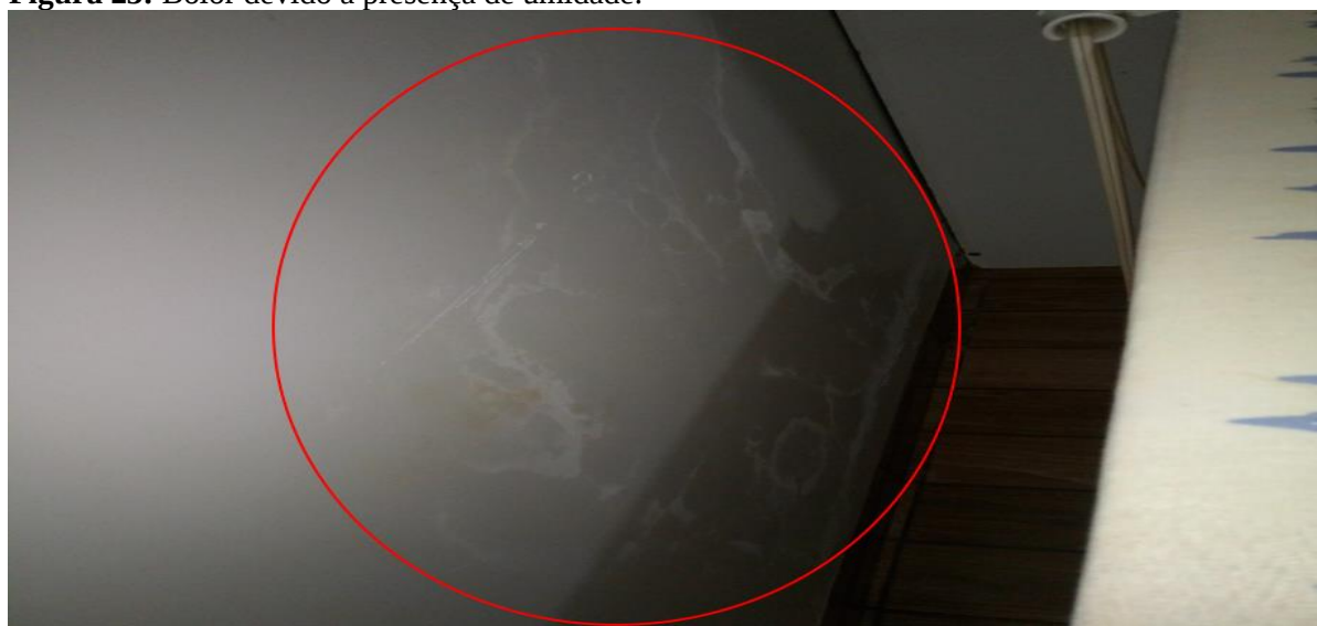
Figura 23: Bolor devido a presença de umidade.
