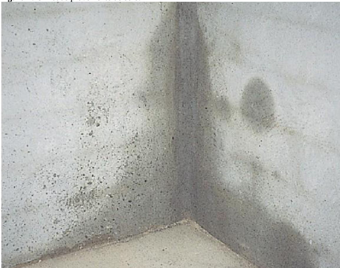
Figura 7: Umidade proveniente do solo.
