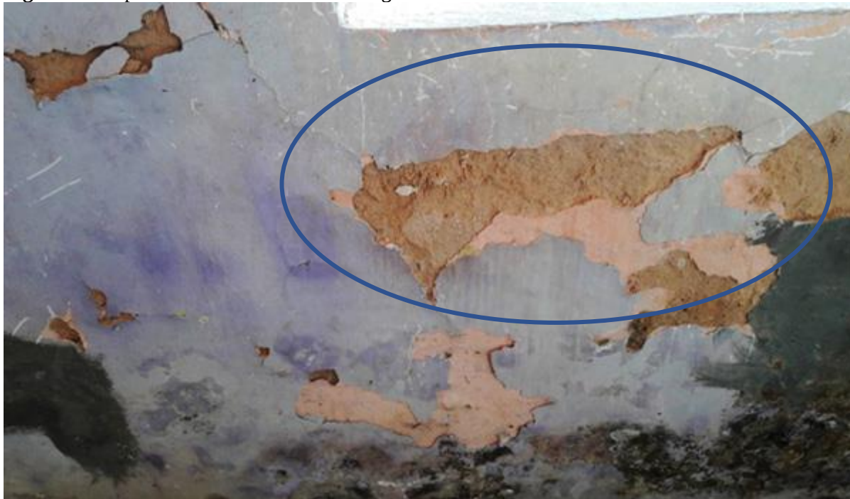
Figura 4: Deslocamento do revestimento argamassado.
