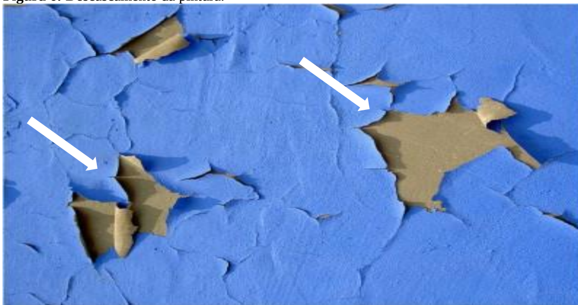
Figura 6: Descascamento da pintura.
