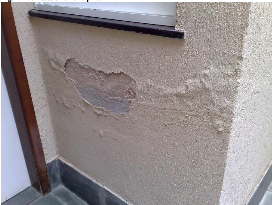
Figura 11: Descolamento na pintura.
