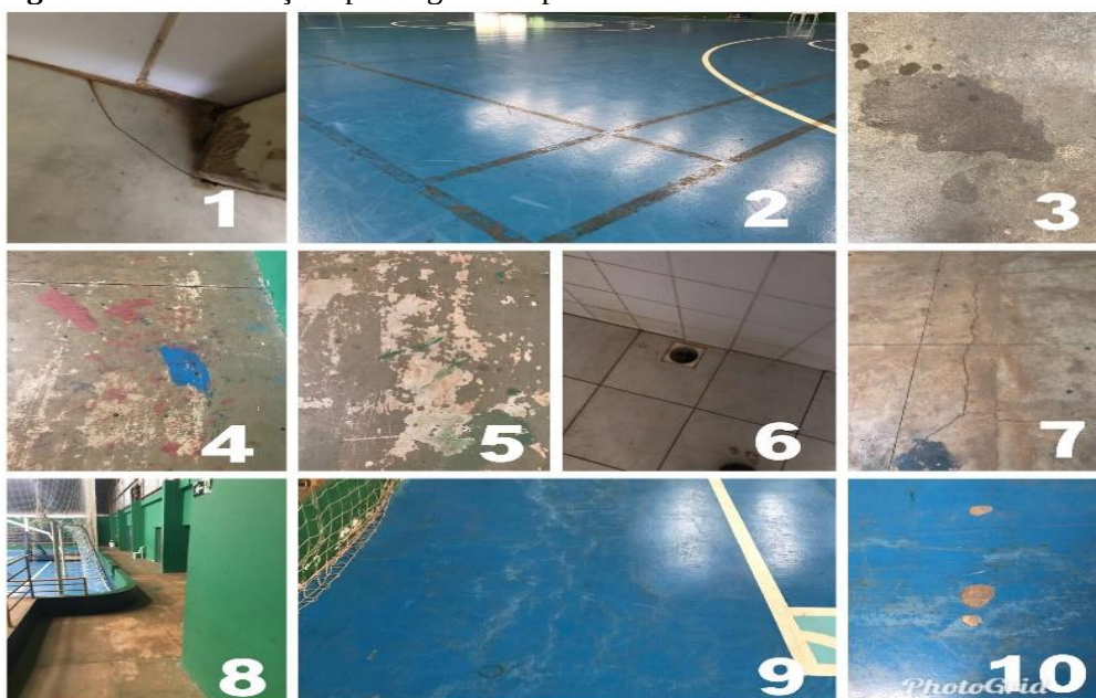
Figura 24: Manifestações patológicas no piso dos ambientes internos.
