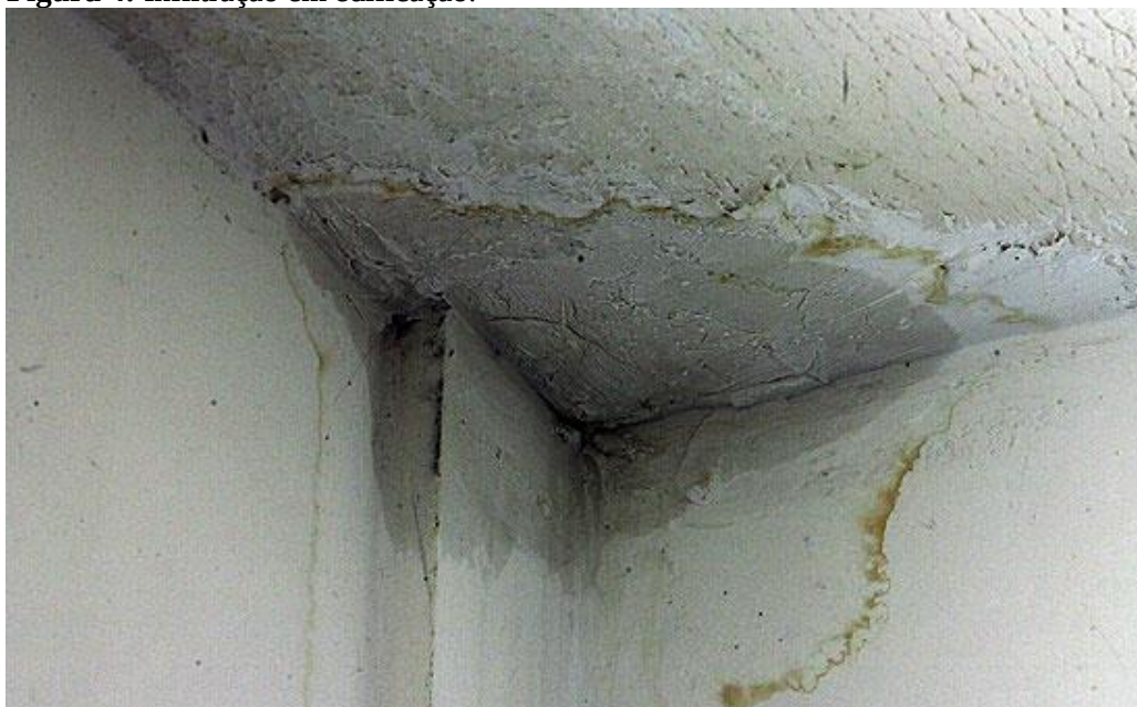
Figura 4: Infiltração em edificação.
