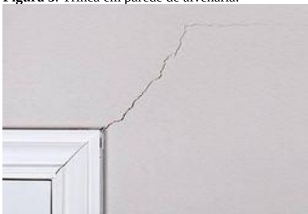
Figura 5: Trinca em parede de alvenaria.
