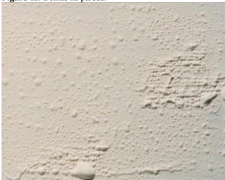
Figura 12: Bolhas na parede.
