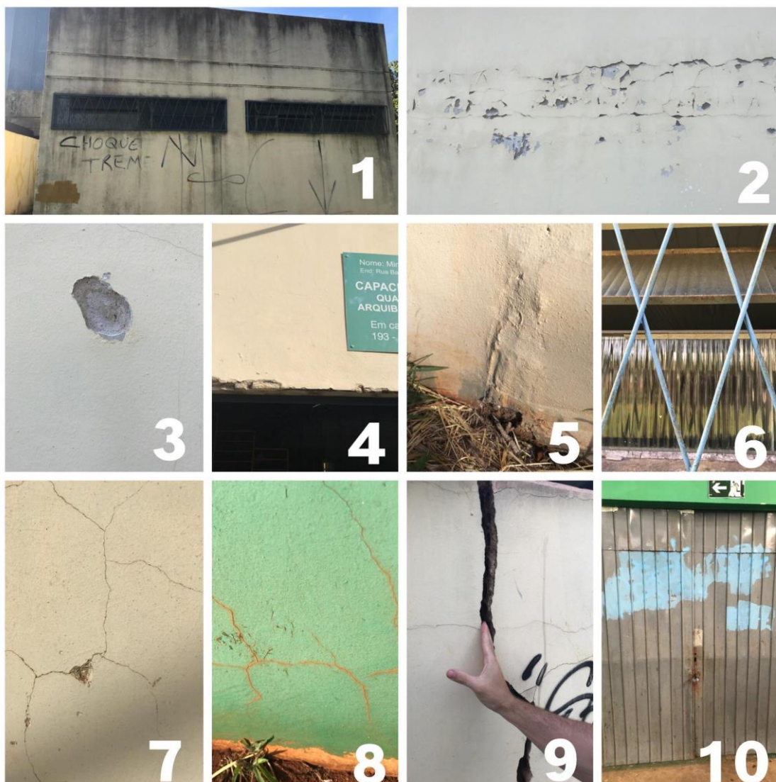
Figura 33: Incidência de patologia no ambiente externo
