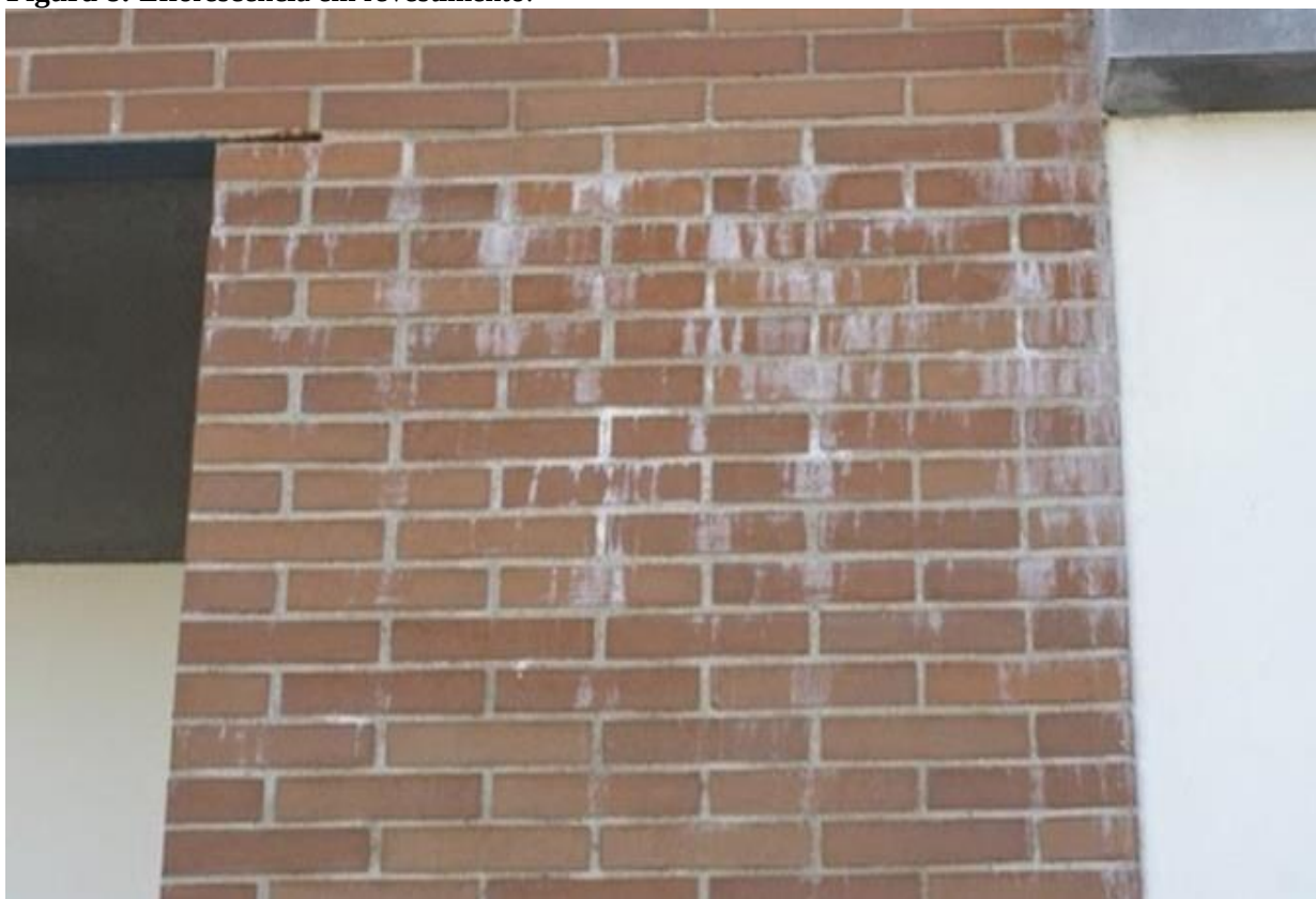
Figura 8: Eflorescência em revestimento.
