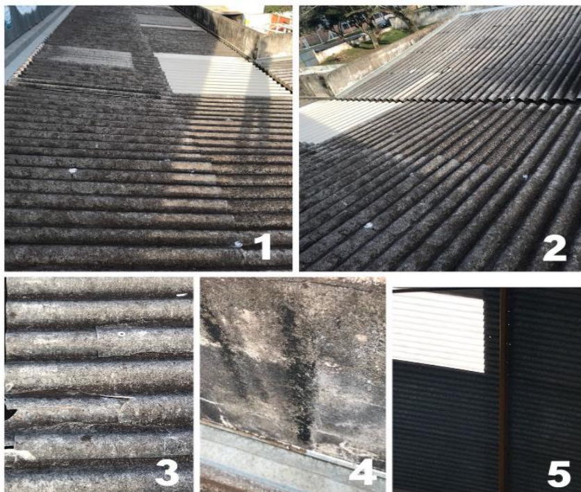
Figura 38: Incidência de patologia na cobertura do complexo.
