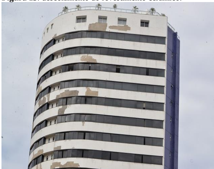
Figura 13: descolamento do revestimento cerâmico.
