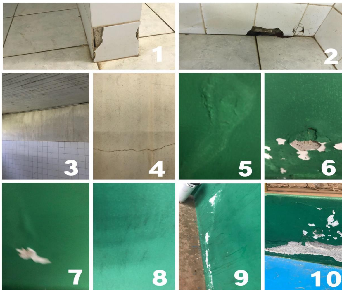
Figura 26: Manifestações patológicas nas paredes dos ambientes internos.
