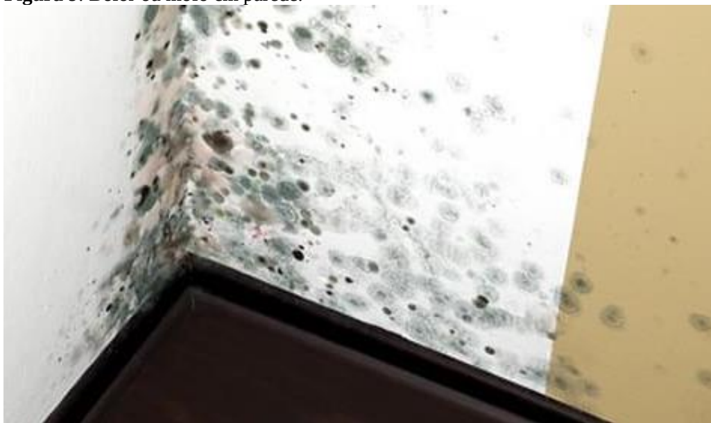
Figura 9: Bolor ou mofo em parede.
