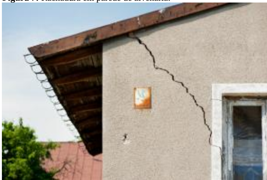
Figura 7: Rachadura em parede de alvenaria.
