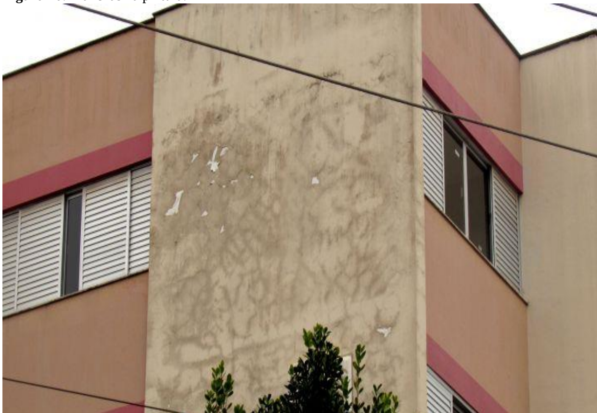
Figura 10: Manchas na pintura.
