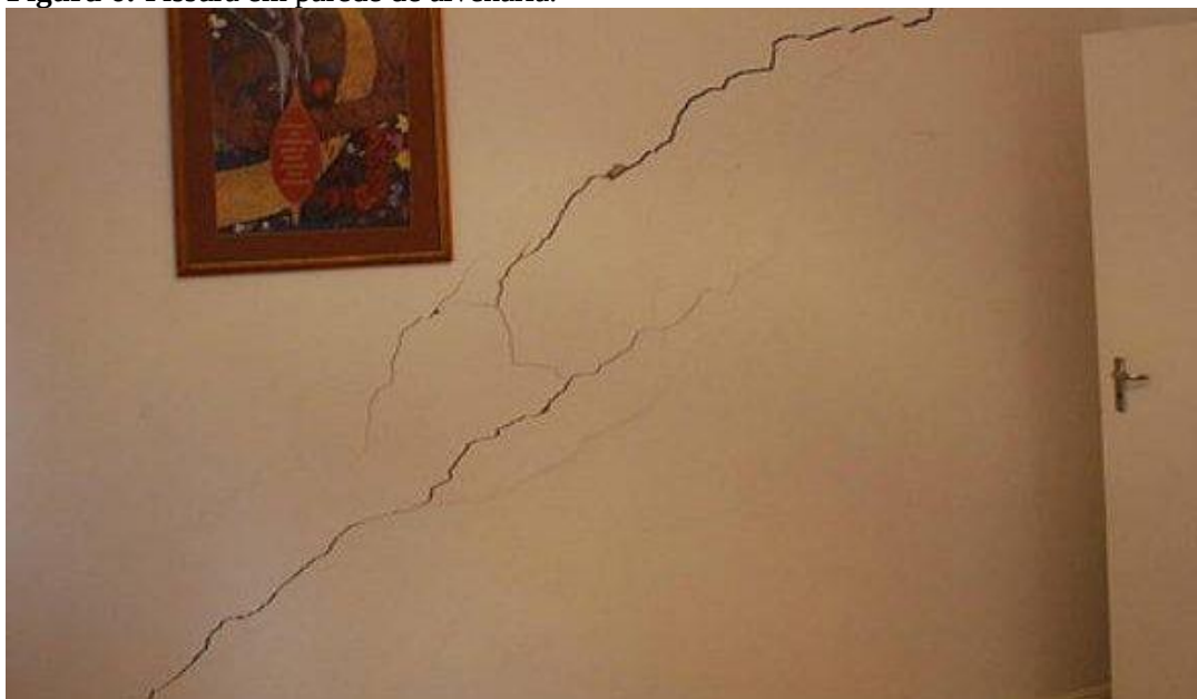
Figura 6: Fissura em parede de alvenaria.
