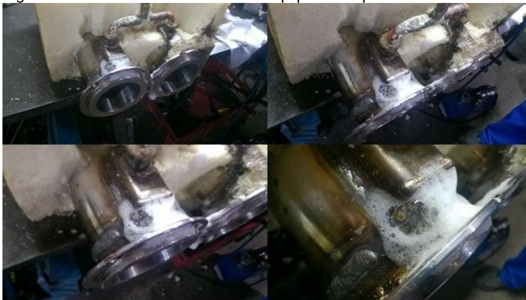
Figura 26 - Vazamento detectado em equipamento pronto
