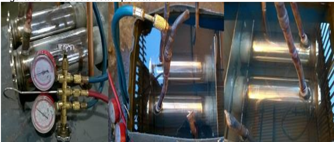
Figura 38 - Teste de estanqueidade
