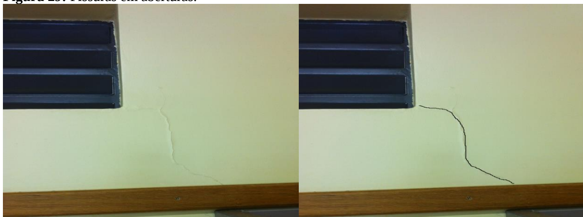
Figura 29: Fissuras em aberturas.
