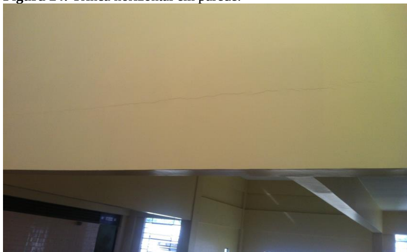
Figura 24: Trinca horizontal em parede.
