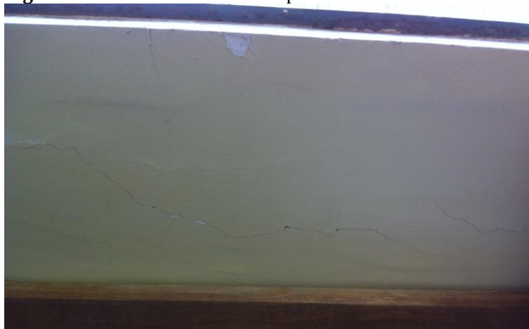
Figura 20: Fissura horizontal em parede.
