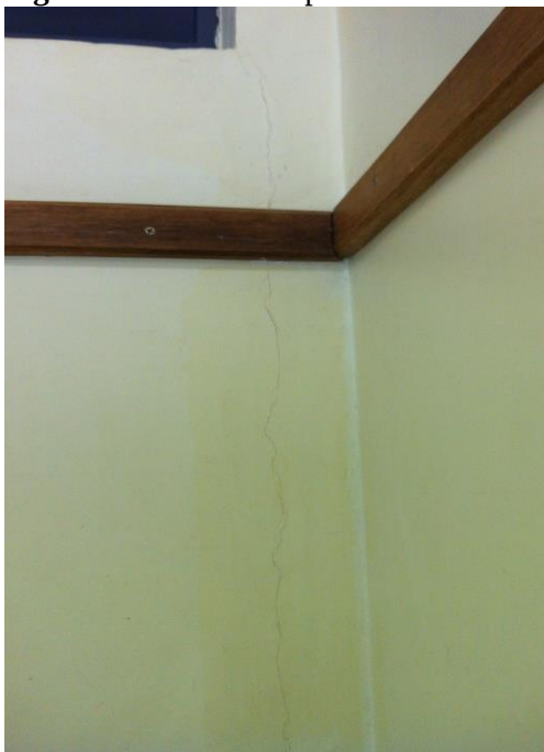
Figura 18: Fissura em parede.
