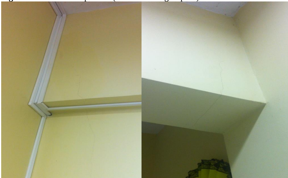
Figura 36: Fissuras em paredes (encontro de viga e pilar).
