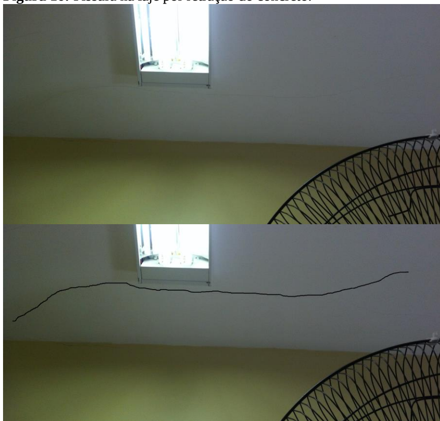
Figura 16: Fissura na laje por retração do concreto.
