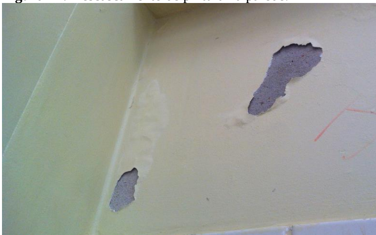
Figura 27: Descascamento de pintura na parede.
