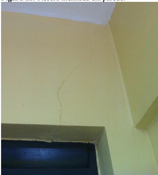
Figura 22: Fissura inclinada em parede.
