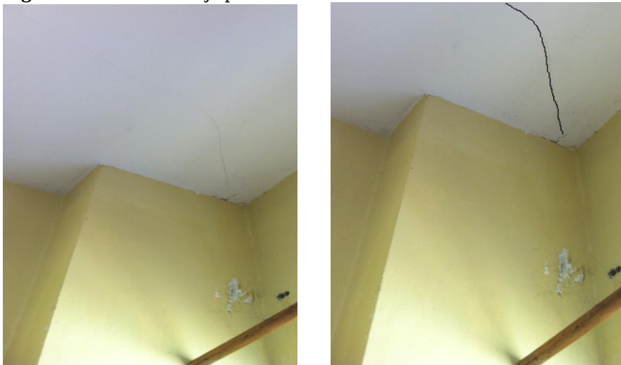
Figura 14: Fissura na laje por flexão.
