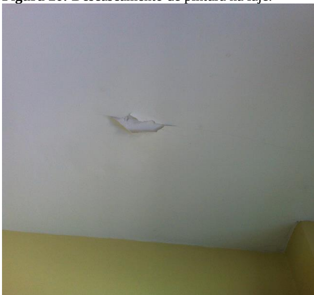
Figura 26: Descascamento de pintura na laje.
