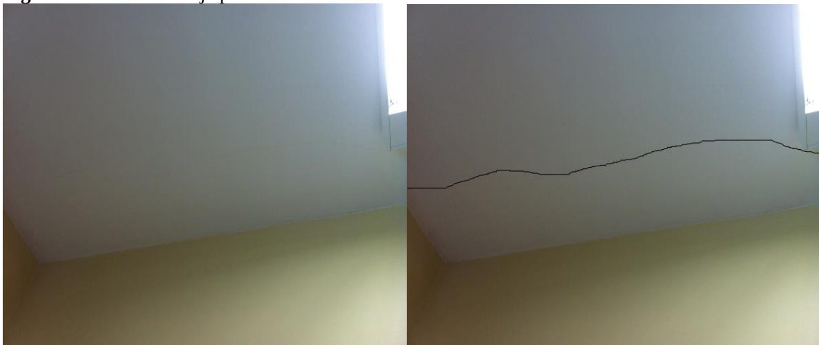
Figura 12: Fissura na laje por subdimensionamento.
