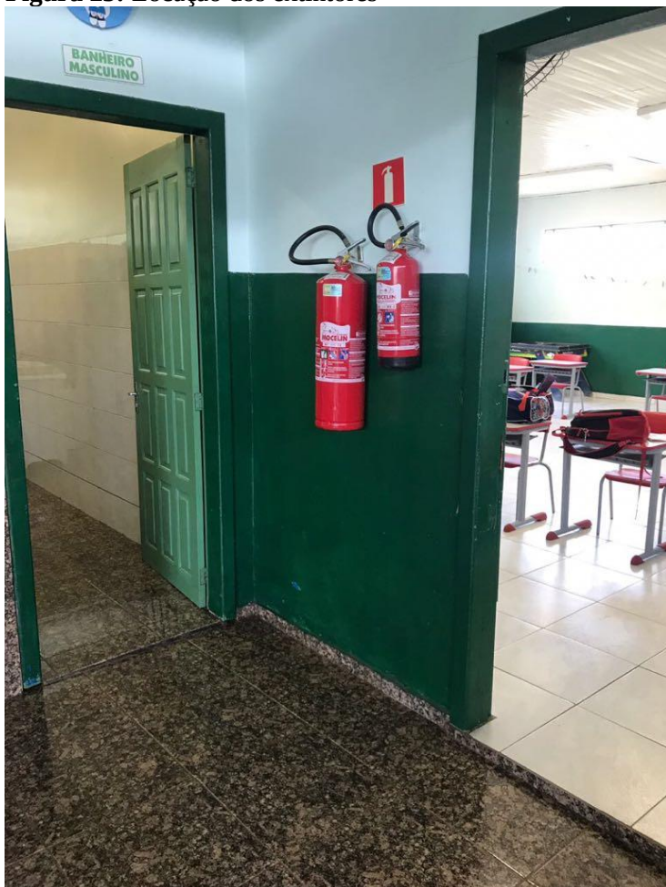
Figura 25: Locação dos extintores
