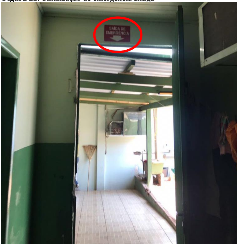
Figura 21: Sinalização de emergência antiga
