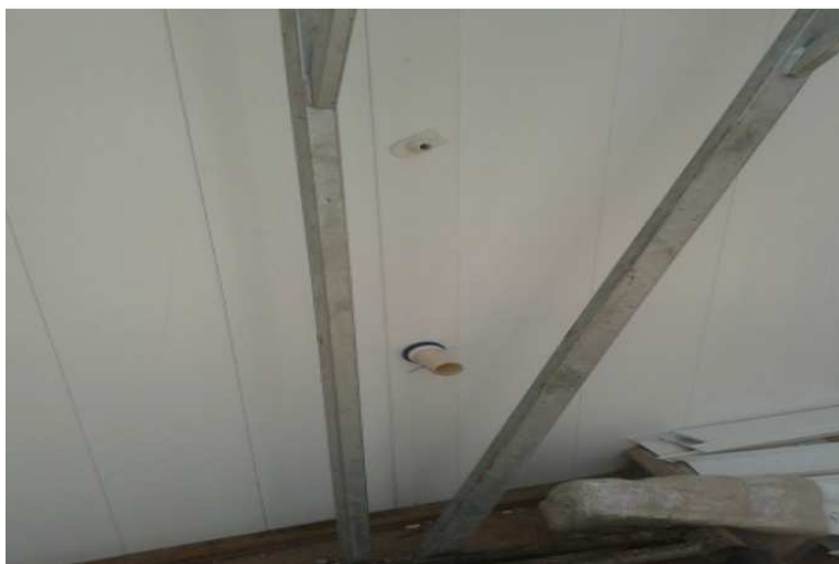
Figura 15: Tubulação hidráulica embutida.
