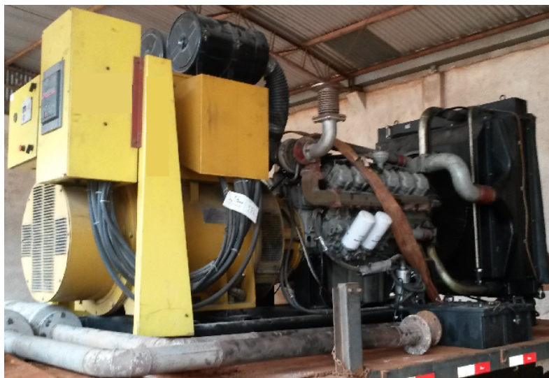
Figura 10: Grupo motor gerador 1.
