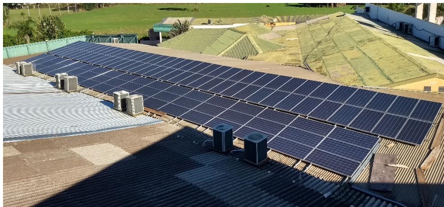
Figura 20 – Placas solares no telhado 2.
