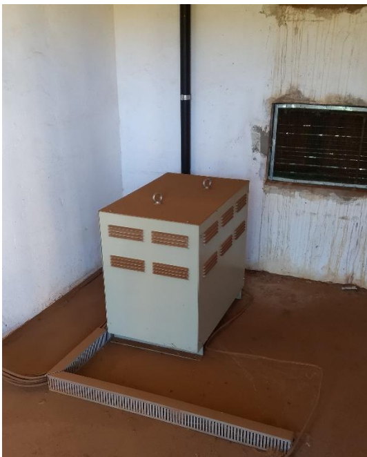
Figura 23 - Local de instalação do transformador rebaixador
