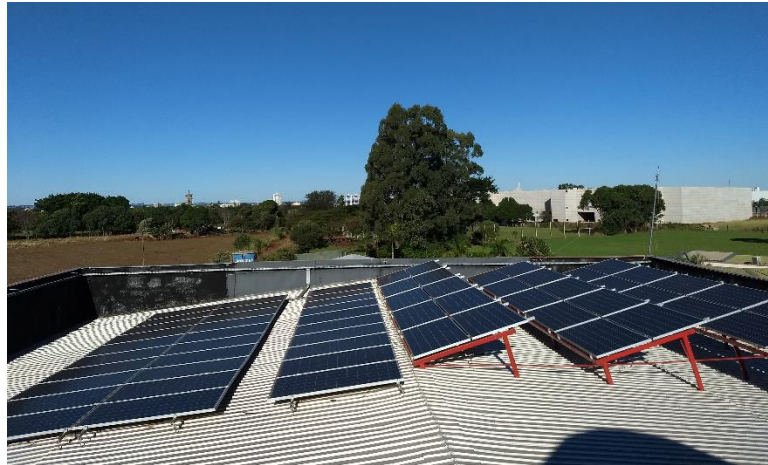
Figura 19 – Placas solares no telhado 1.
