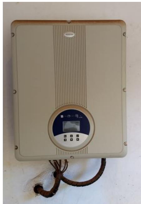
Figura 22 – Inversor Fotovoltaico utilizado
