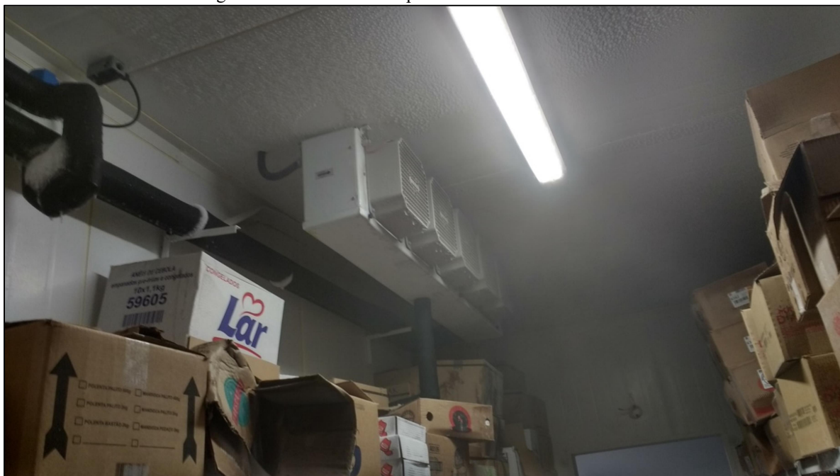
Figura 4 - Um dos dois evaporadores instalados na câmara.
