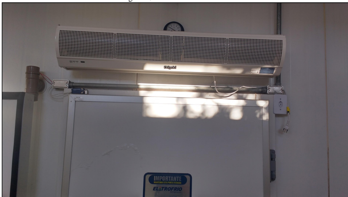
Figura 10 - Cortina de ar instalada.
