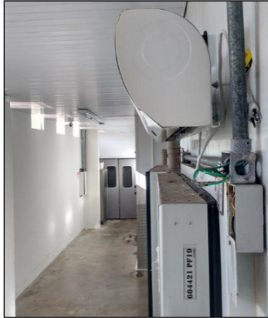
Figura 11 - Vista lateral da cortina de ar instalada.
