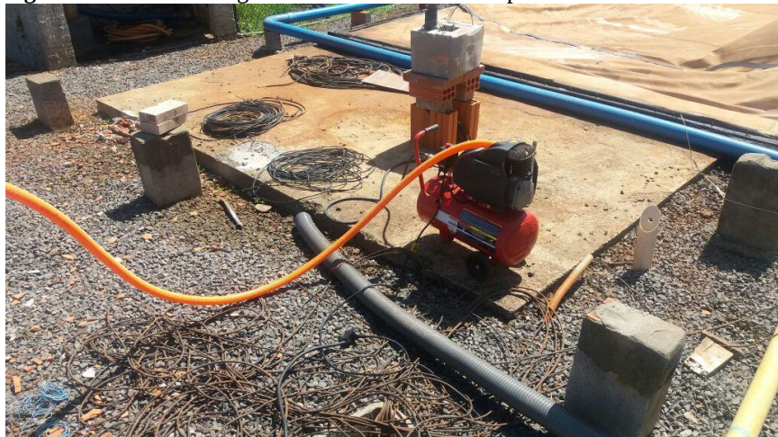
Figura 16: Eletroduto ligado a entrada de ar do compressor
