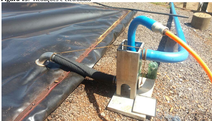
Figura 15: Reduções e eletroduto
