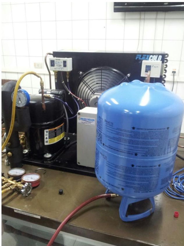
Figura 14 – Fluido refrigerante sendo colocado no sistema
