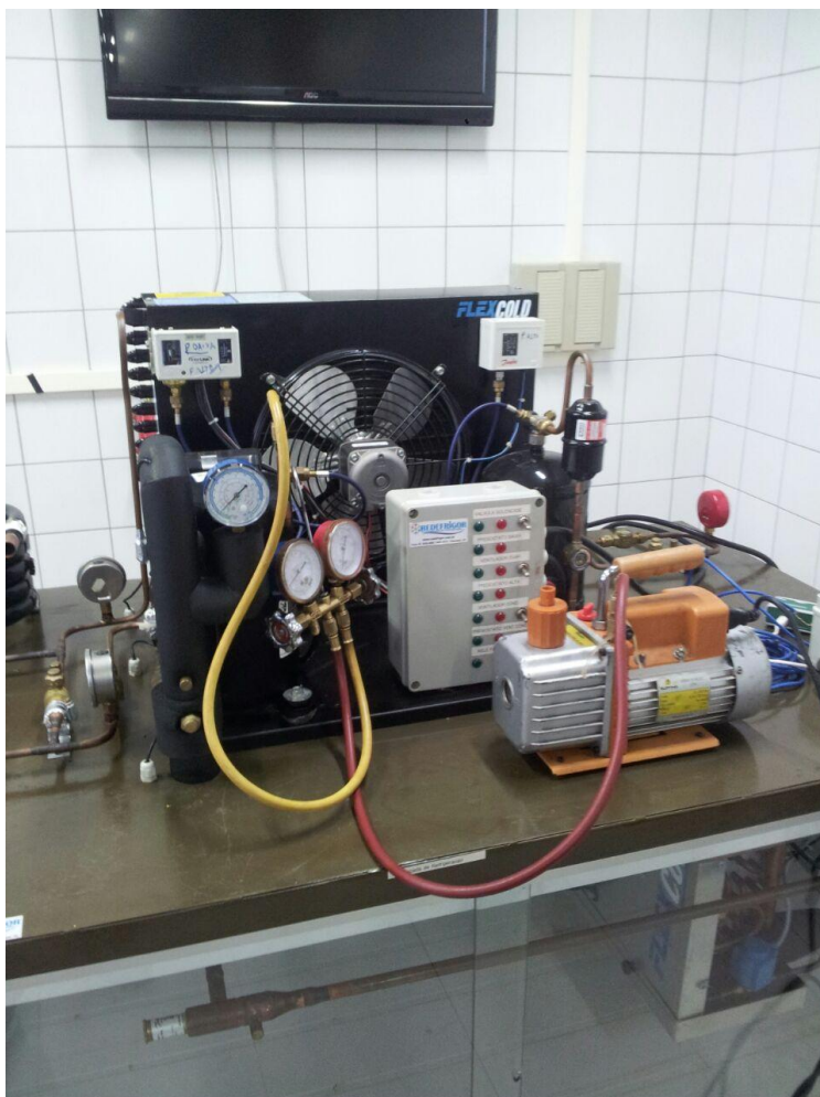
Figura 13 – Central de Refrigeração
