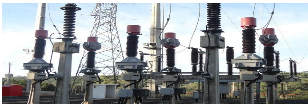
Figura 9 -Transformador de potencial
