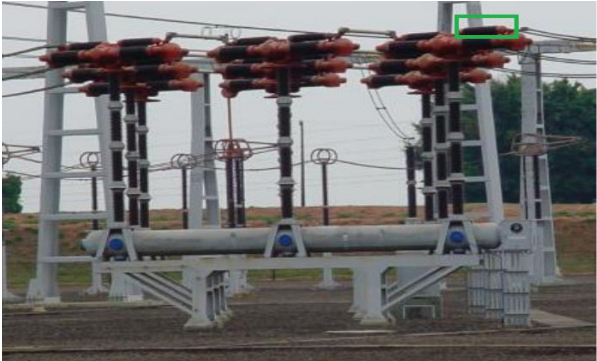
Figura 17 - Localização capacitores em disjuntor de AT
