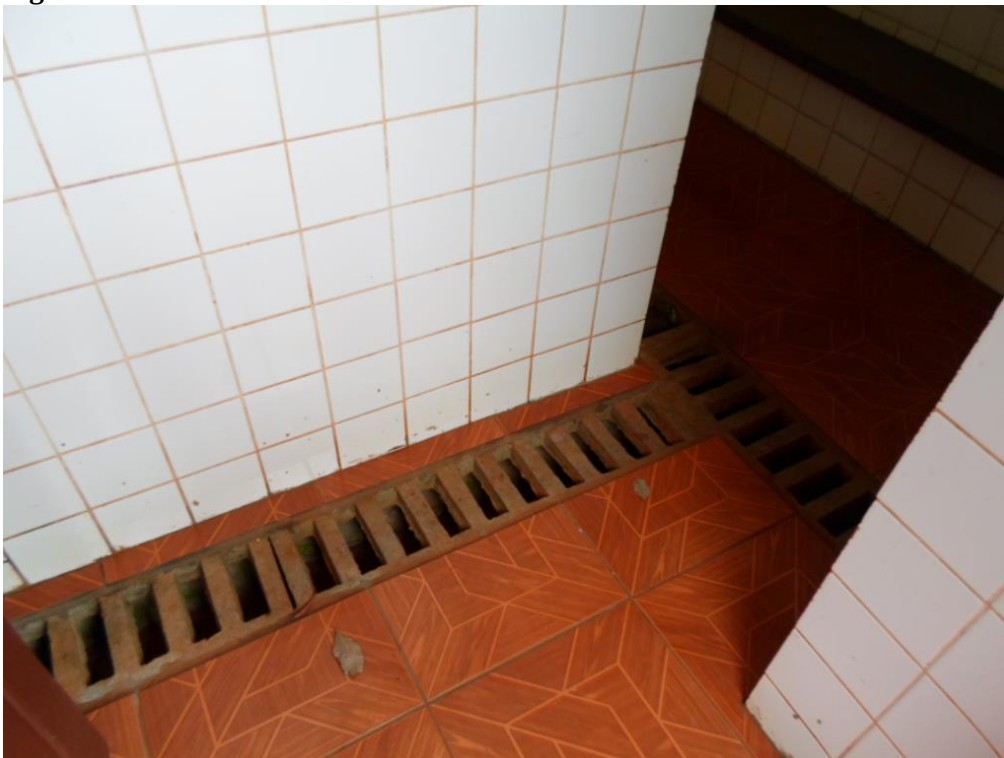
Figura 23: Estrutura interna das Duchas.
