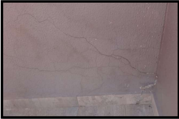
Figura 13 - Fissuras e microfissuras mapeadas na parede que faz divisa com outro imóvel do mesmo condomínio.
