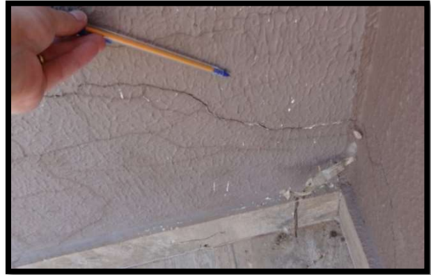
Figura 14 - Fissuras e microfissuras mapeadas na parede que faz divisa com outro imóvel do mesmo condomínio.
