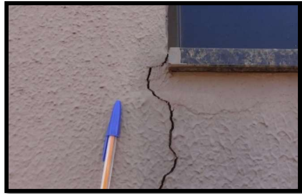
Figura 12 - Trincas apresentadas na janela do BWC.
