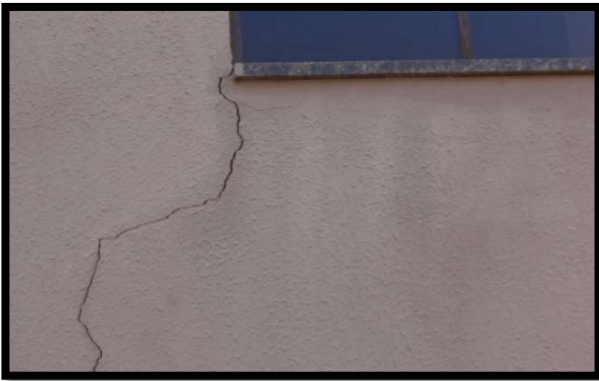
Figura 11 - Trincas apresentadas na janela do BWC.
