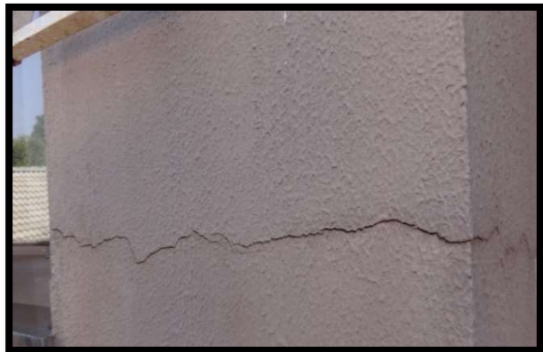
Figura 09 - Fissuração e trincas guarda corpo da sacada da suíte.
