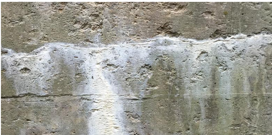
Figura 6: Eflorescência em concreto.
