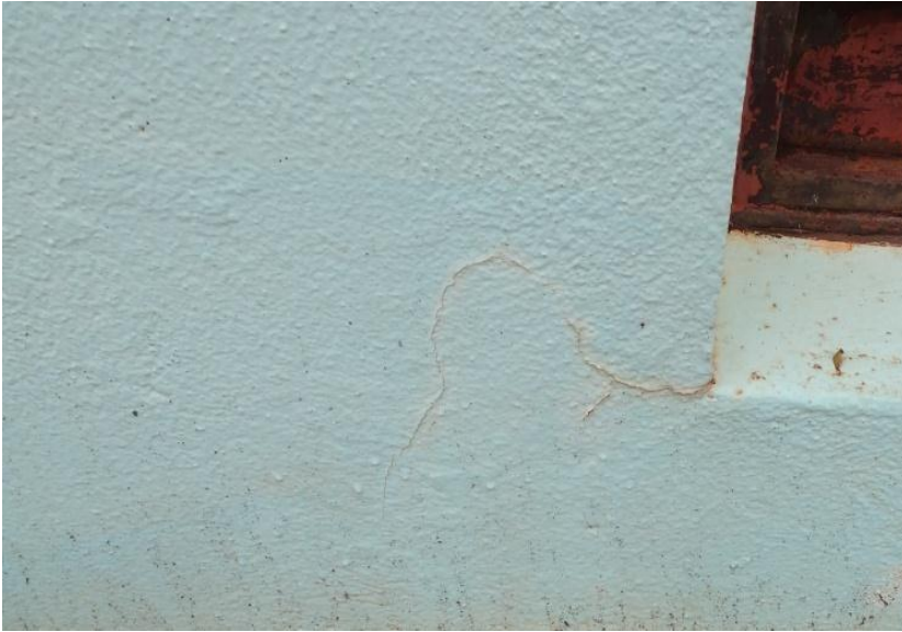
Figura 17: Trincas em aberturas.
