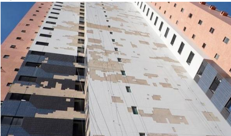
Figura 1: Descolamento em argamassa.
