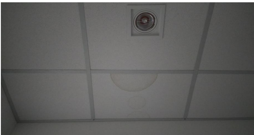
Figura 20: Manchas no teto.
