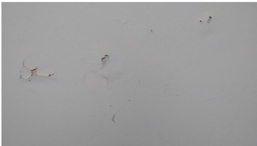
Figura 21: Descascamento de pintura na parede.
