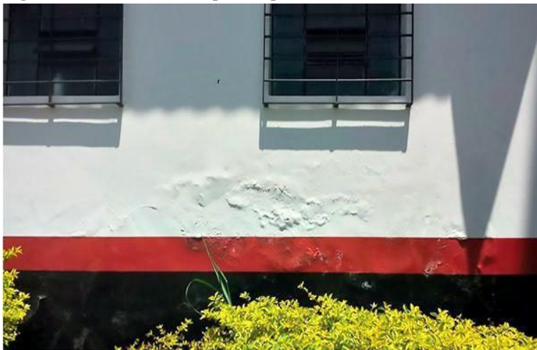
Figura 2: Descolamento por empolamento.
