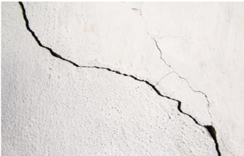
Figura 4: Fissura em parede.
