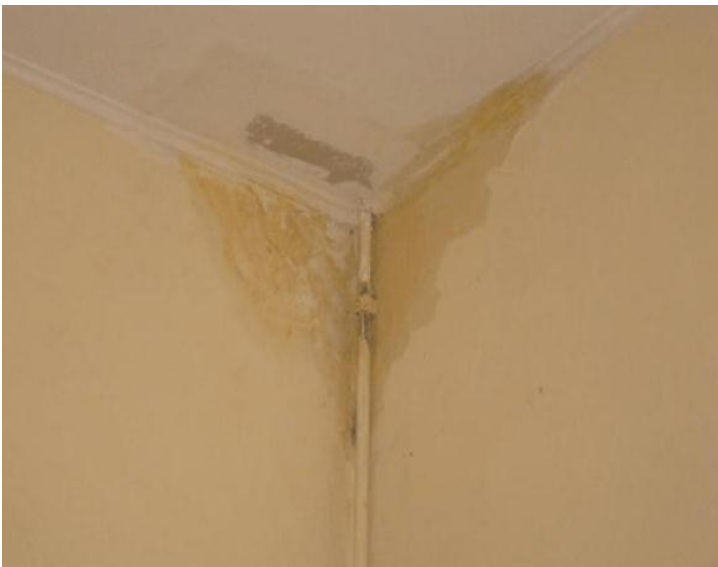
Figura 5: Manchas em parede.
