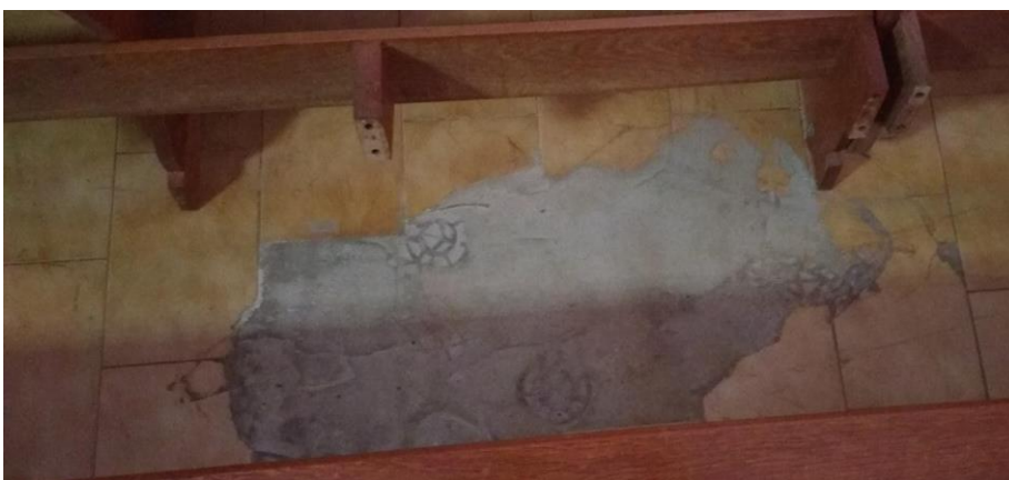
Figura 19: Danos em elementos cerâmicos.
