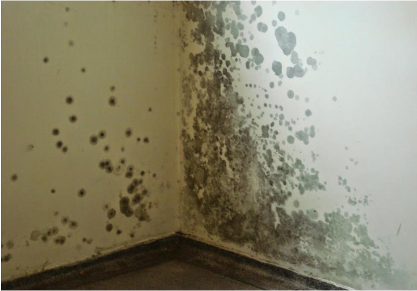
Figura 7: Bolors em paredes.
