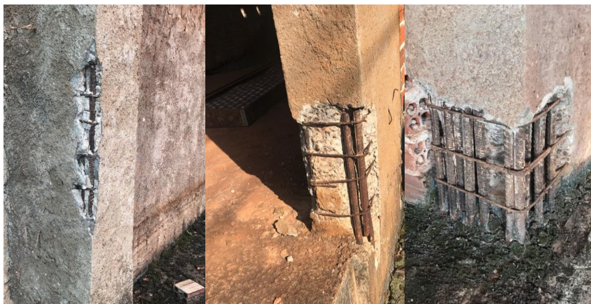
Figura 06 – Corrosão das armaduras dos pilares
