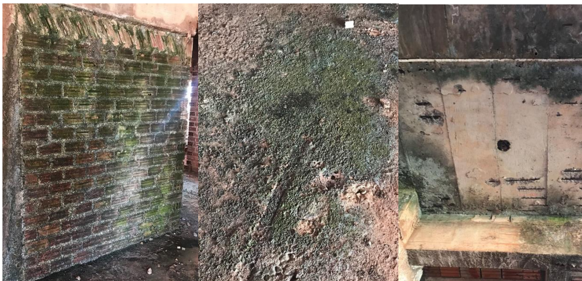
Figura 04 – Mofo na parede, piso e laje
