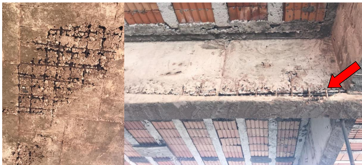
Figura 08 – Falta de cobrimento na laje e na viga com armadura em processo de corrosão
