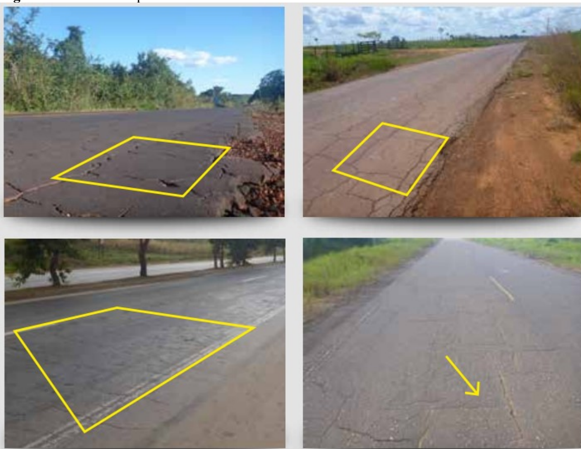
Figura 5: Trincas do tipo bloco.
