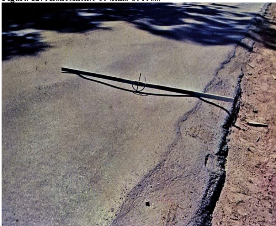
Figura 12: Afundamento de trilha de roda.
