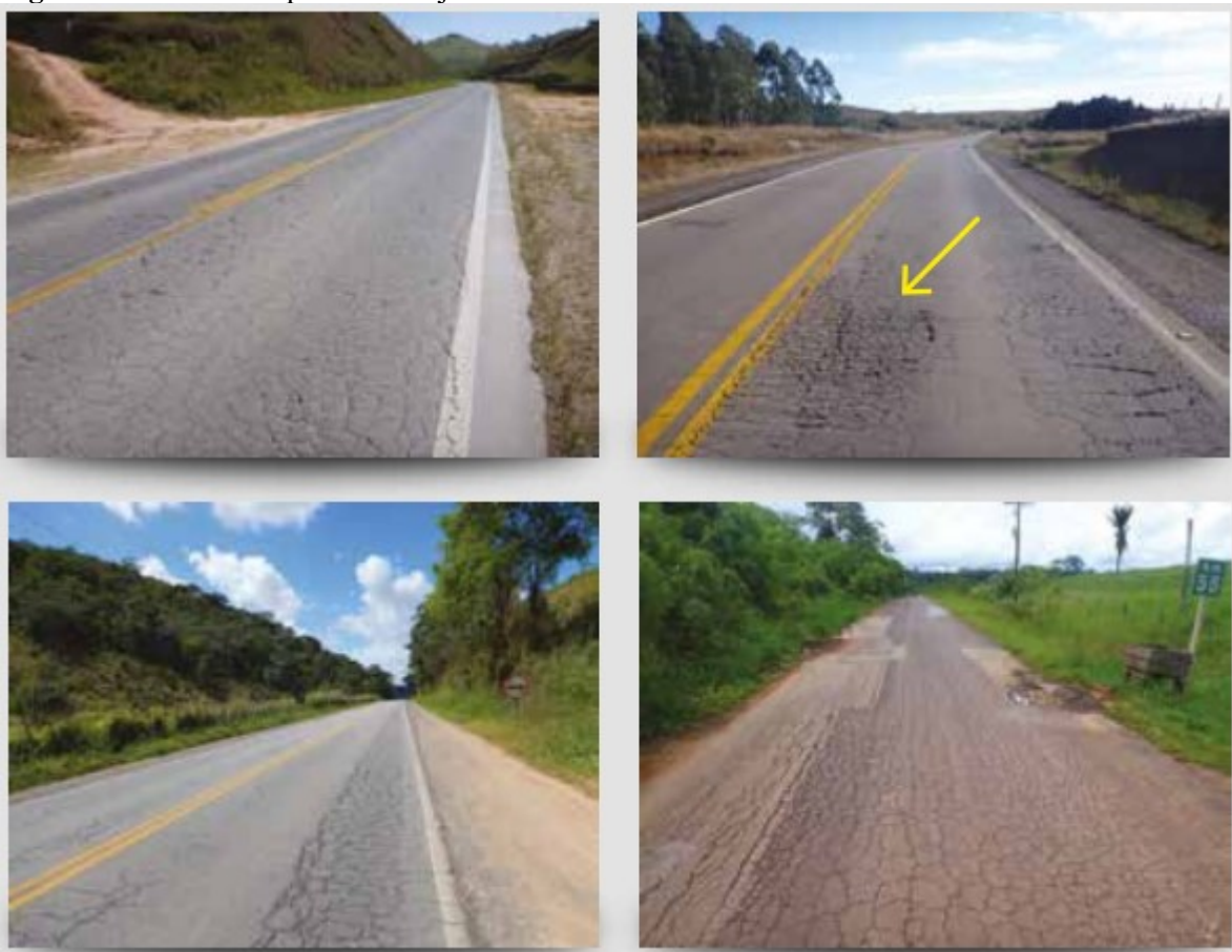
Figura 2: Trincas do tipo couro de jacaré.
