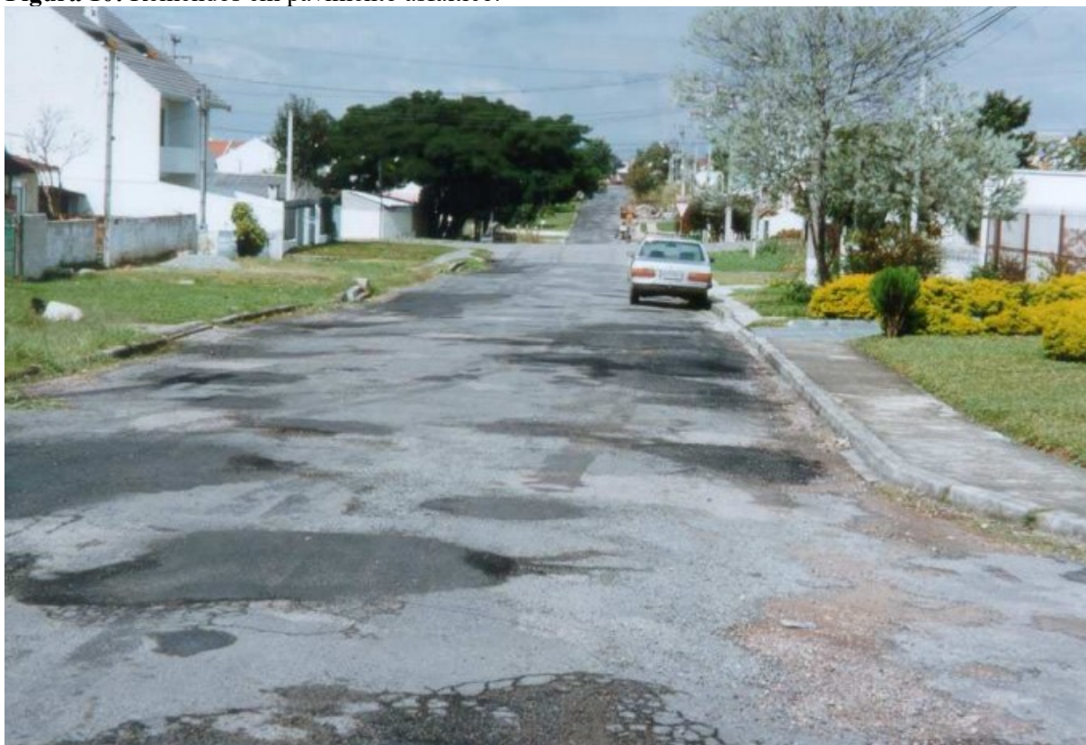
Figura 10: Remendos em pavimento asfáltico.
