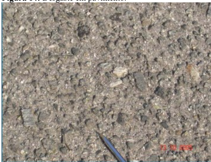
Figura 14: Desgaste em pavimento.
