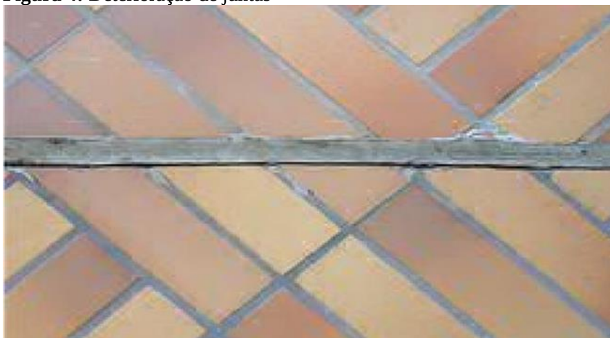
Figura 4: Deterioração de juntas
