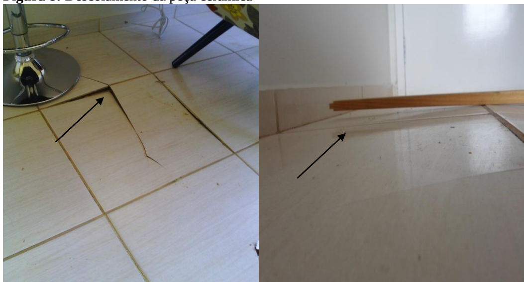
Figura 8: Descolamento da peça cerâmica
