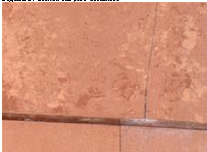
Figura 3: Trinca em piso cerâmico
