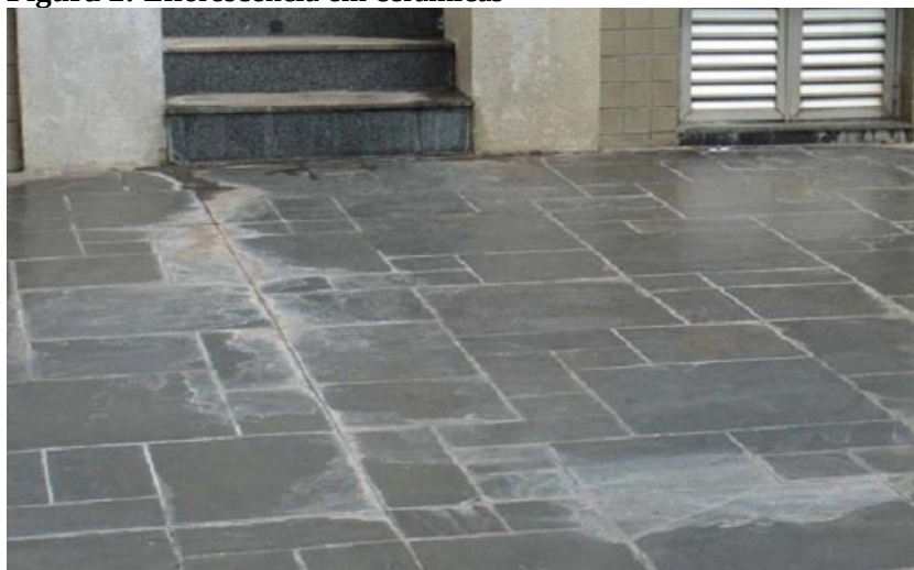
Figura 2: Eflorescência em cerâmicas
