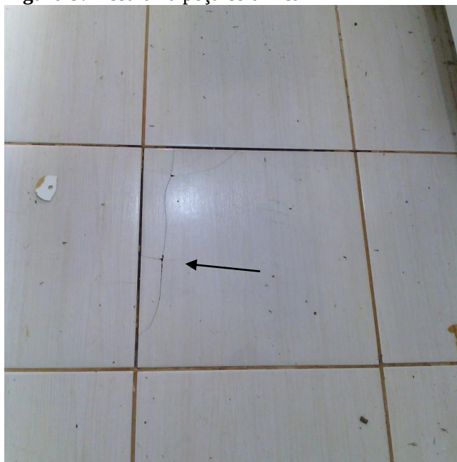
Figura 9: Fissura na peça cerâmica
