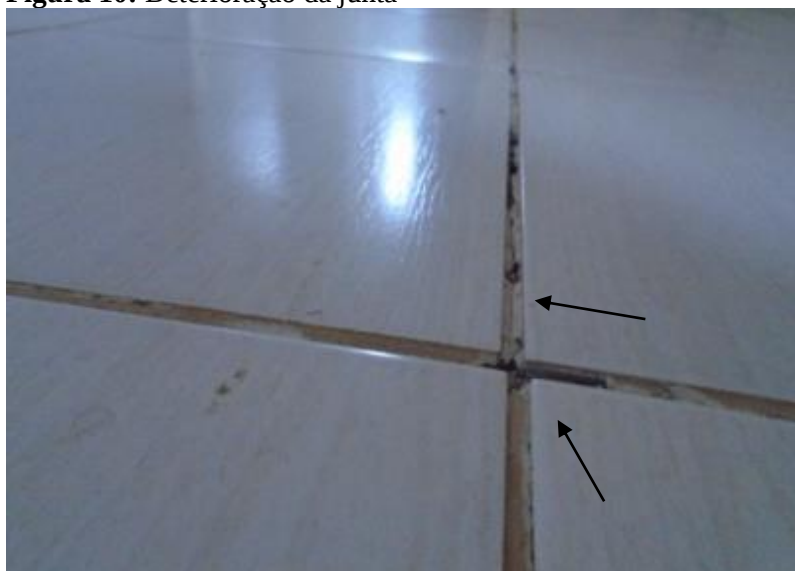
Figura 10: Deterioração da junta
