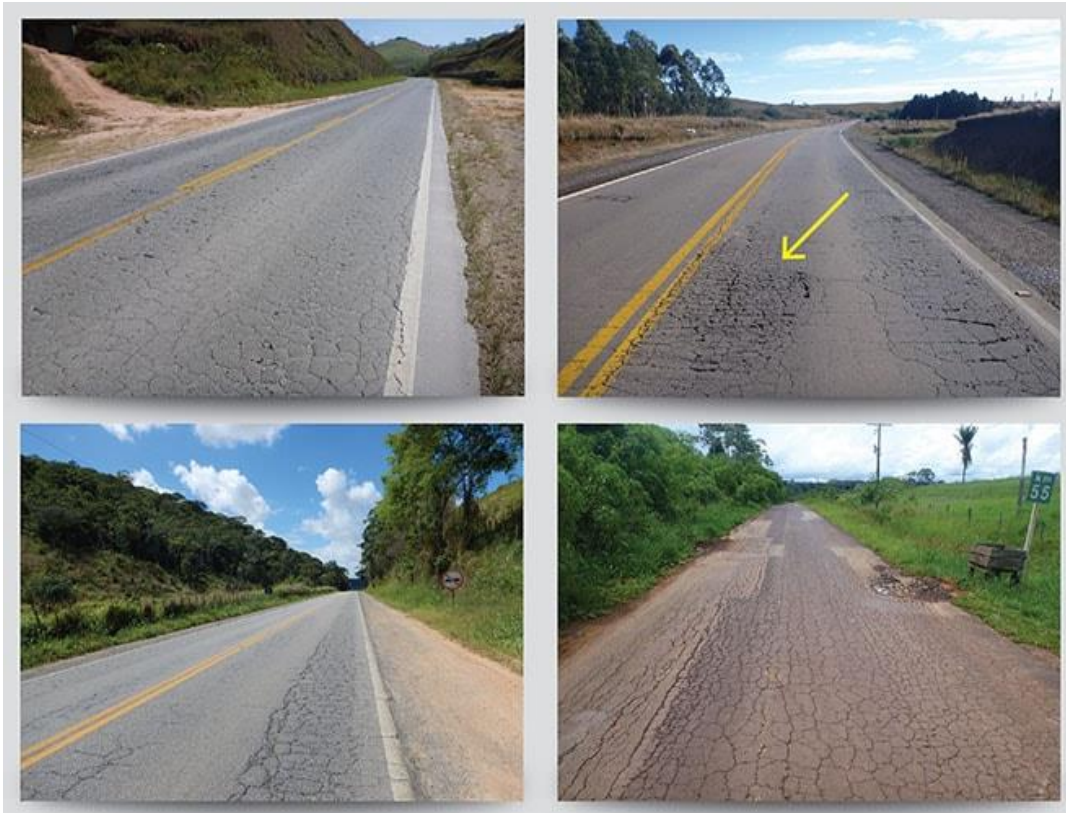
Figura 4 - Trinca tipo “Couro de Jacaré”
