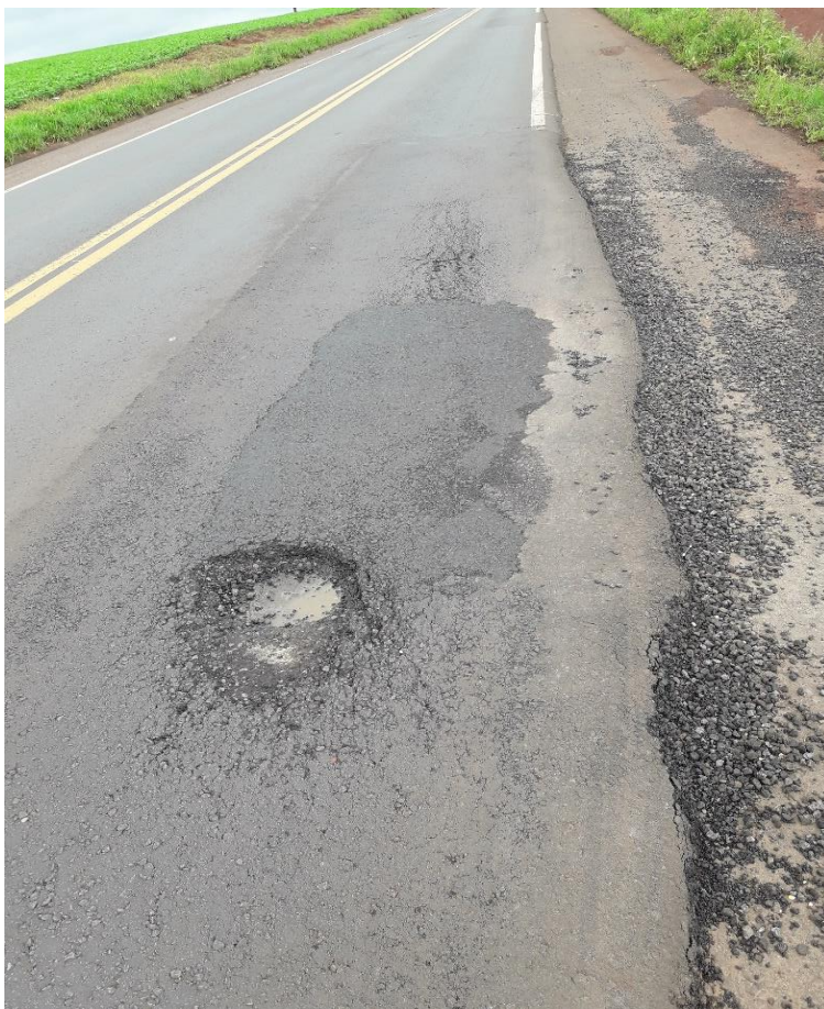
Figura 15 – Remendo contendo Panela, Trincas, Escorregamento e Desgaste
