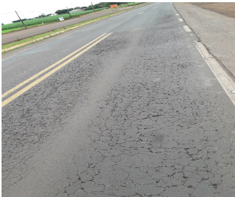
Figura 13 – Trinca do tipo “Jacaré”
