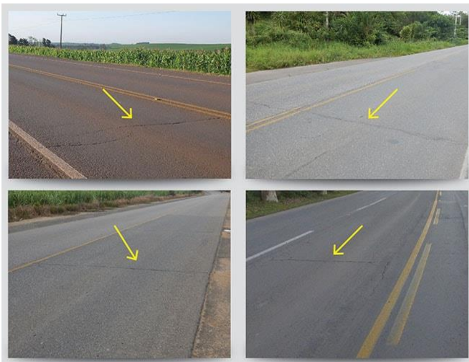
Figura 2 - Trinca isolada - Transversal
