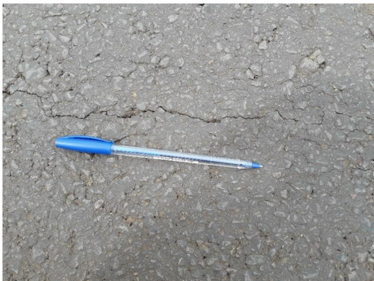
Figura 12 – Tamanho da fissura comparada a uma caneta.
