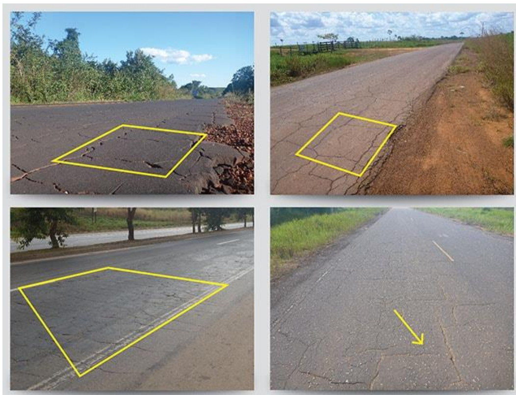
Figura 5 - Trinca tipo “Bloco”
