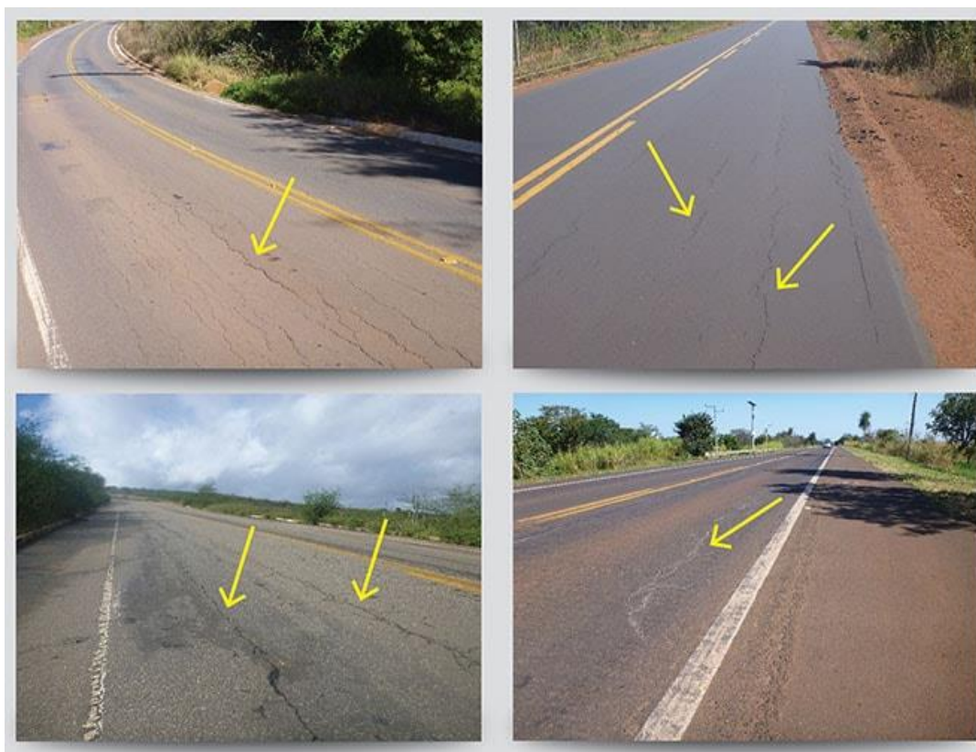
Figura 3 - Trinca isolada – Longitudinal
