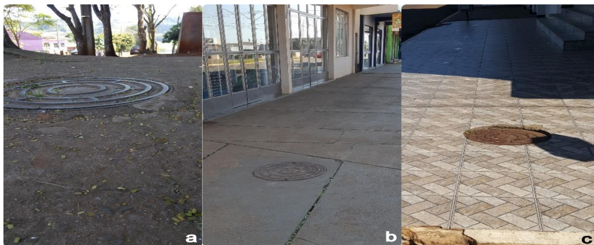
Figura 8: Tampas de Inspeção
