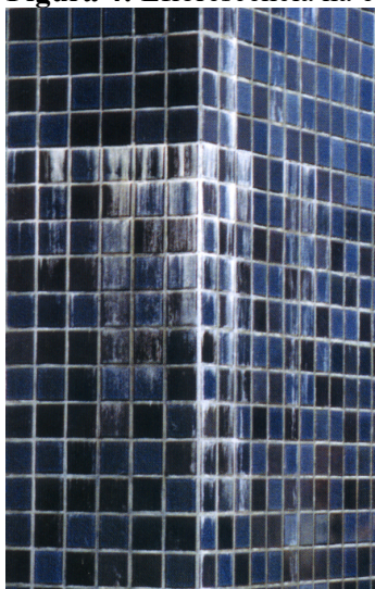
Figura 4: Eflorescência na edificação
