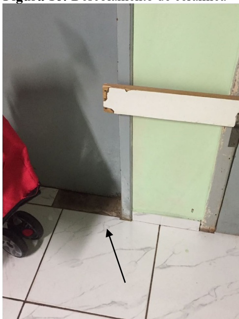
Figura 16: Descolamento de cerâmica
