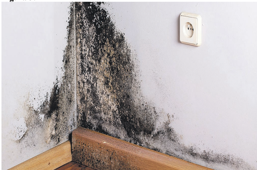
Figura 3: Parede de alvenaria com bolor ou mofo
