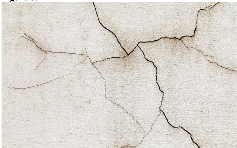
Figura 5: Trincas na alvenaria
