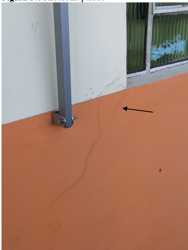
Figura 14: Fissura na parede
