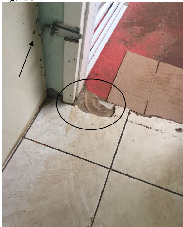
Figura 31: Descolamento de cerâmica
