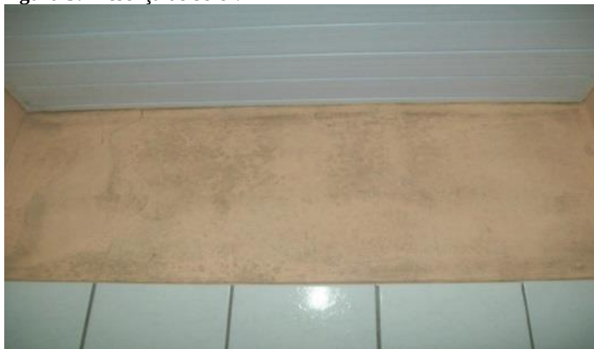
Figura 3: Presença de bolor.
