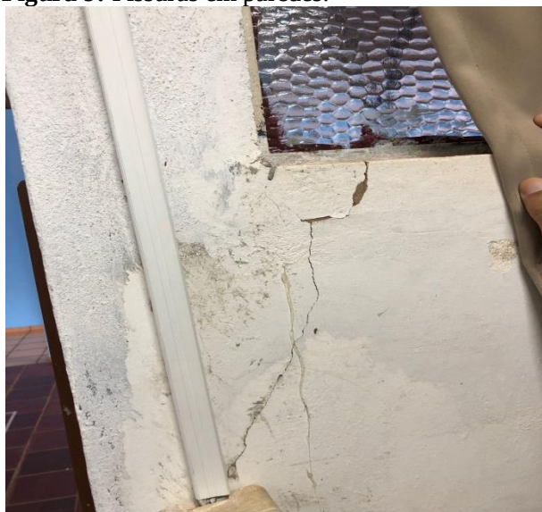
Figura 9: Fissuras em paredes.
