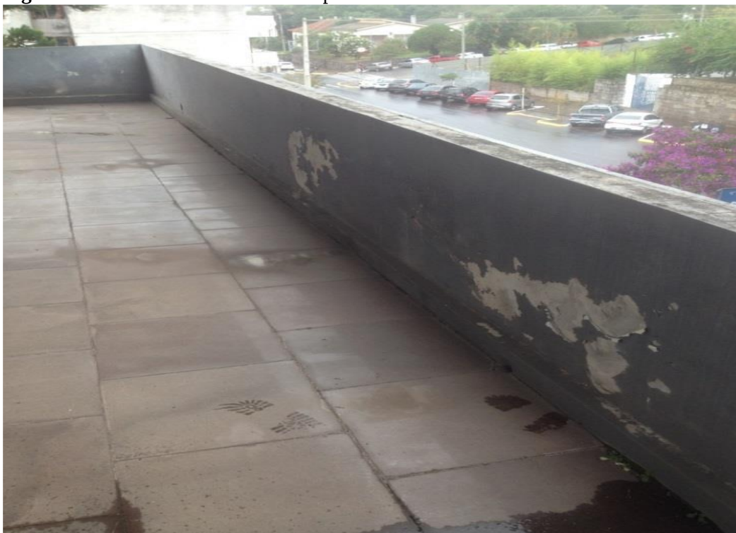
Figura 3: Manchas de bolor causadas por umidade excessiva.
