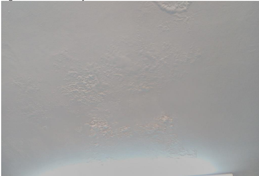
Figura 13: Bolhas na laje.
