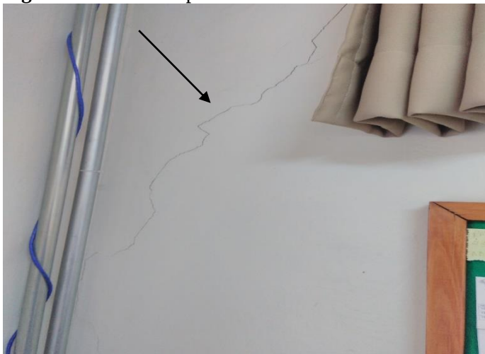
Figura 8: Fissura em parede.
