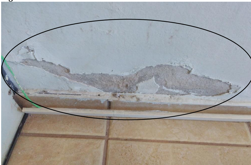
Figura 12: Descolamento do revestimento.
