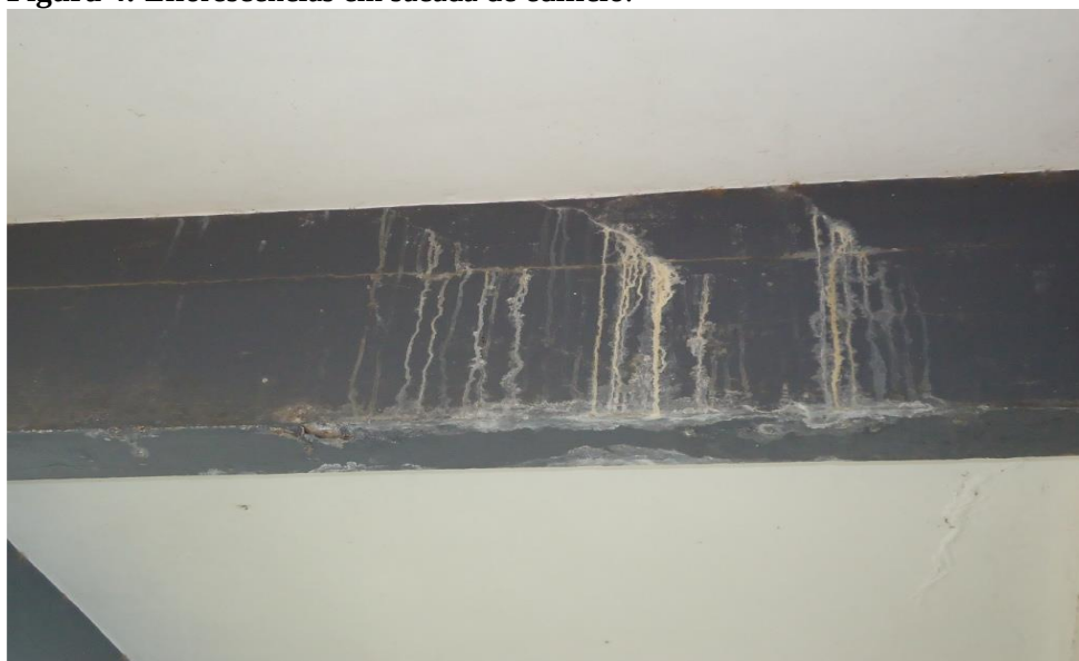
Figura 4: Eflorescências em sacada de edifício.
