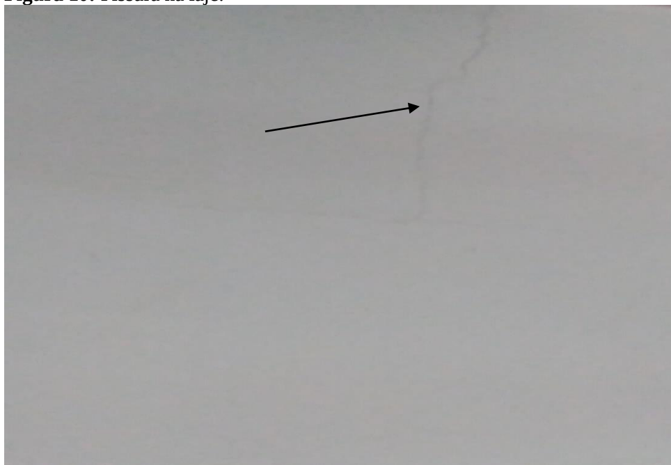
Figura 10: Fissura na laje.
