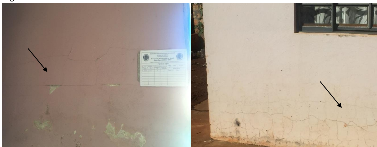
Figura 09 – Fissuras na área interna/externa
