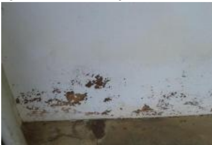
Figura 06 – Descascamento da pintura
