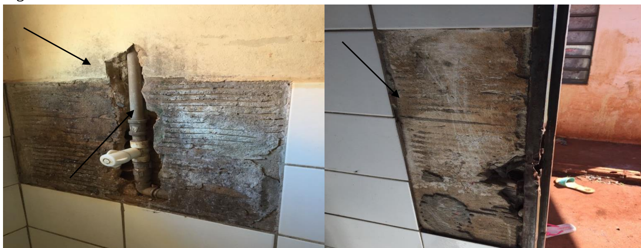
Figura 11 – Descolamento do revestimento cerâmico
