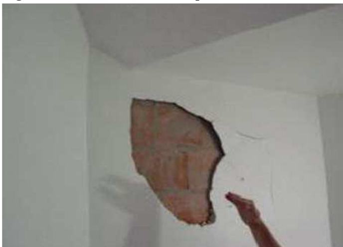
Figura 05 - Descolamento em parede de alvenaria
