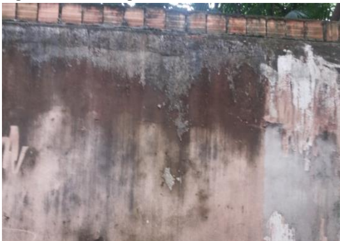
Figura 04 - Mofo ligado à existência de umidade
