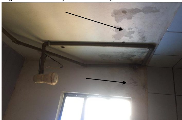
Figura 13– Presença de mofo na parede e teto
