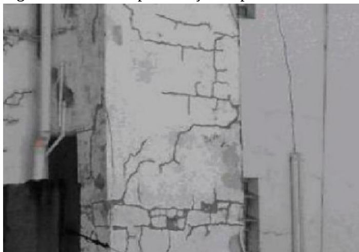
Figura 02 - Fissuras por retração de produtos cimentícios
