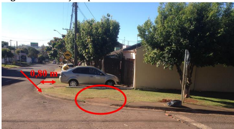
Figura 107: Calçada parcialmente em acordo com a NBR 9050 (ABNT, 2015)
