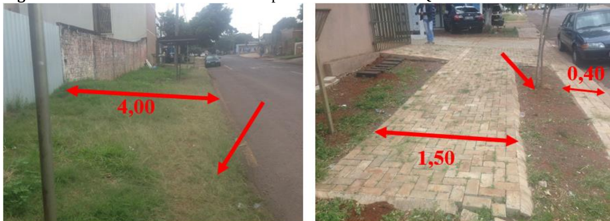
Figura 83: Ausência de revestimento ou piso tátil em trecho da Quadra 210 A
