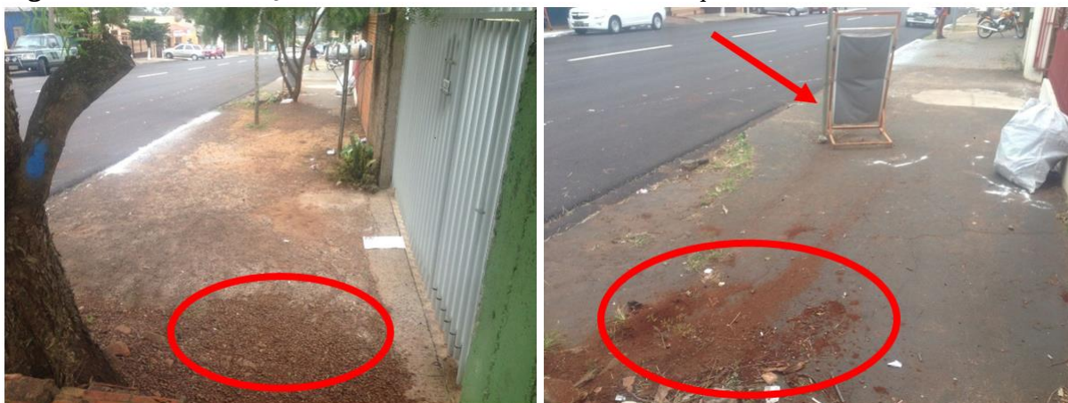
Figura 42: Trecho da Quadra 209A com revestimento inadequado
