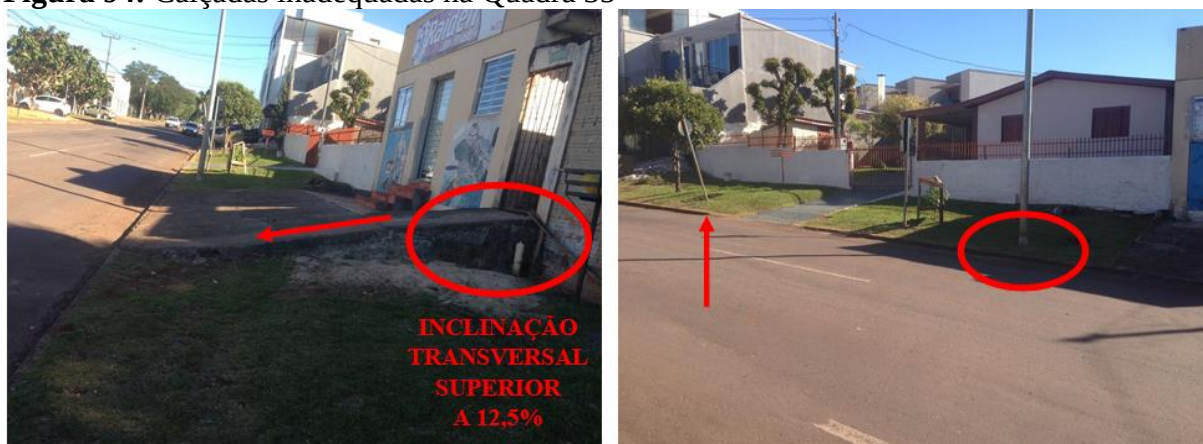
Figura 94: Calçadas inadequadas na Quadra 35
