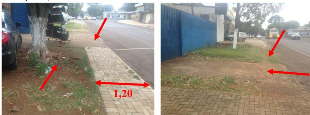
Figura 84: Revestimento parcial junto ao meio fio e ausência de vegetação em área de circulação de pedestres
