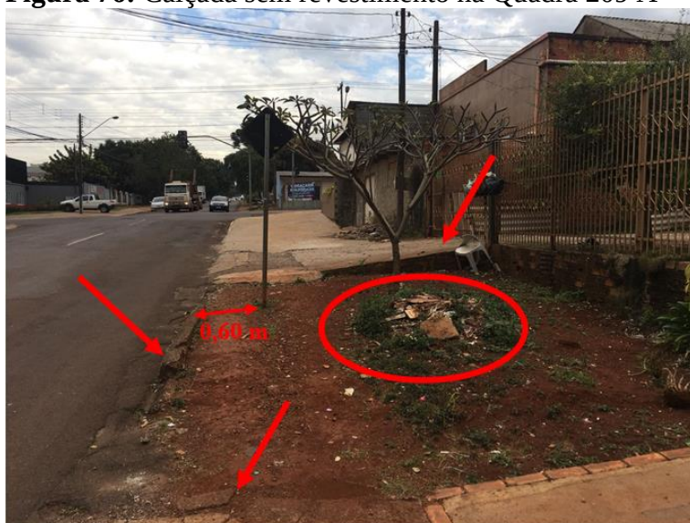
Figura 76: Calçada sem revestimento na Quadra 209 A
