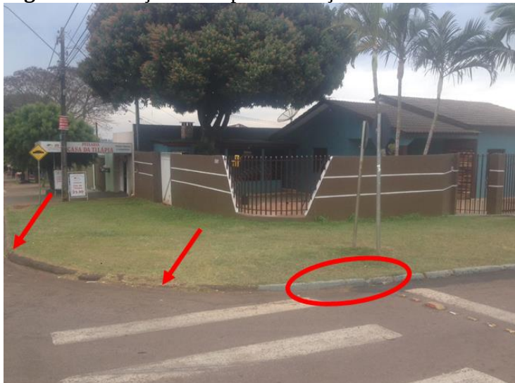
Figura 81: Calçada sem pavimentação e rebaixo com rampa na esquina
