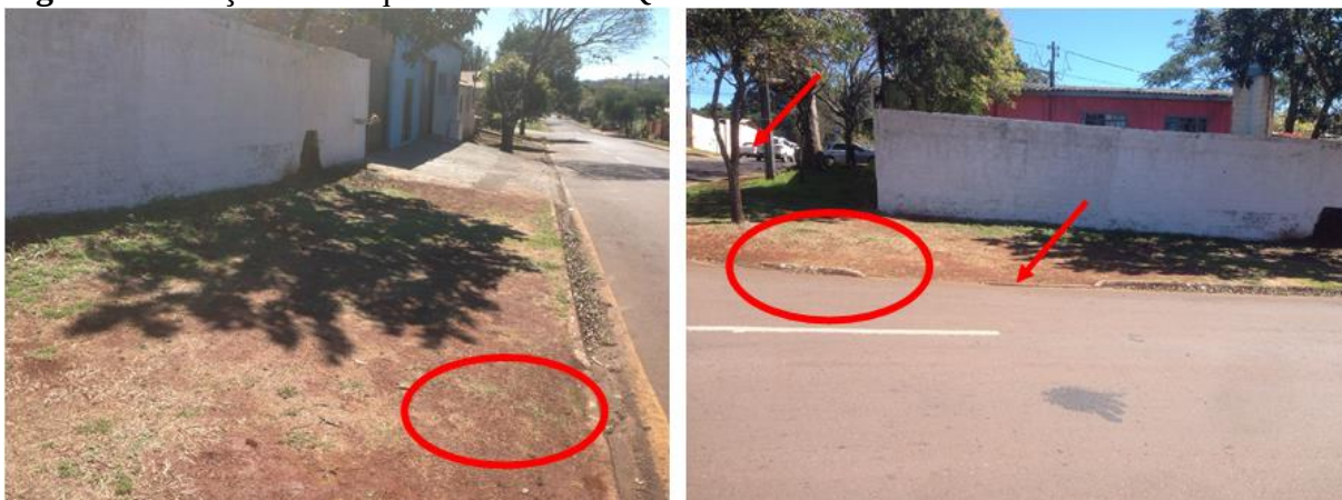
Figura 92: Calçada inadequada ao final da Quadra 31 – Trecho 4
