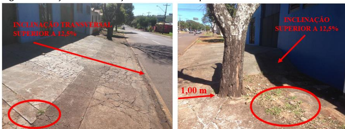
Figura 91: Calçada com inclinação transversal inadequada
