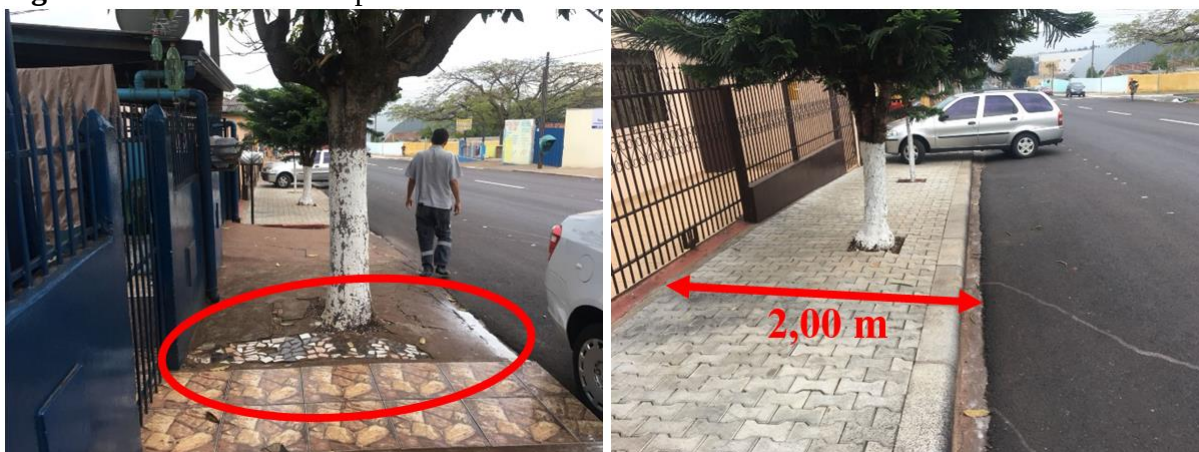
Figura 37: Inexistência de piso tátil direcional e alerta
