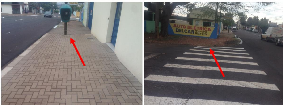
Figura 44: Esquina da Quadra 209A e inexistência de rampa de acesso
