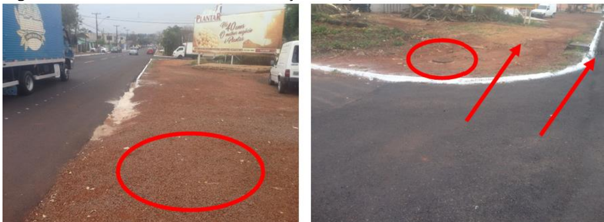
Figura 66: Ausência de revestimento na calçada da Quadra 31
