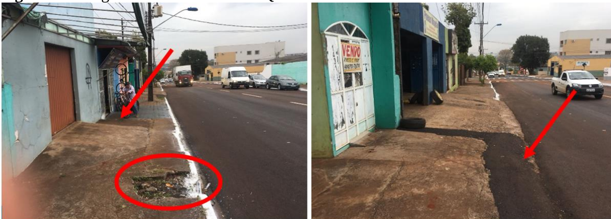
Figura 39: Irregularidade em trecho da Quadra 05
