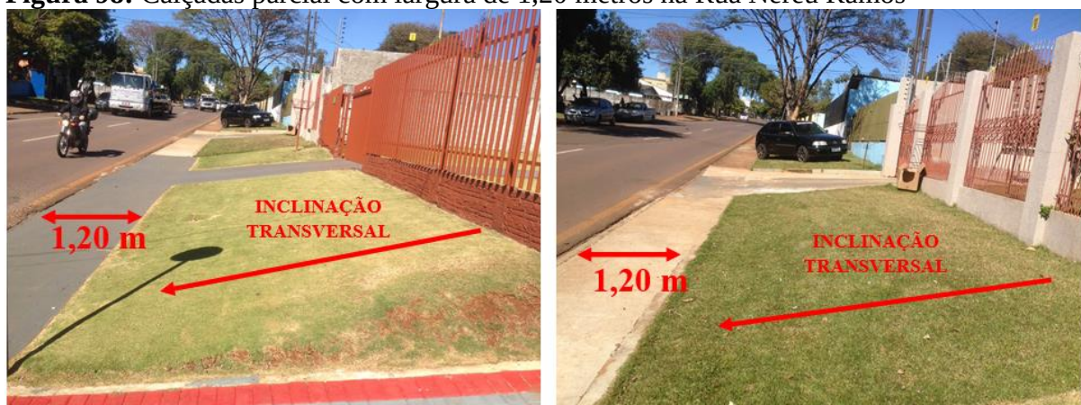
Figura 98: Calçadas parcial com largura de 1,20 metros na Rua Nereu Ramos
