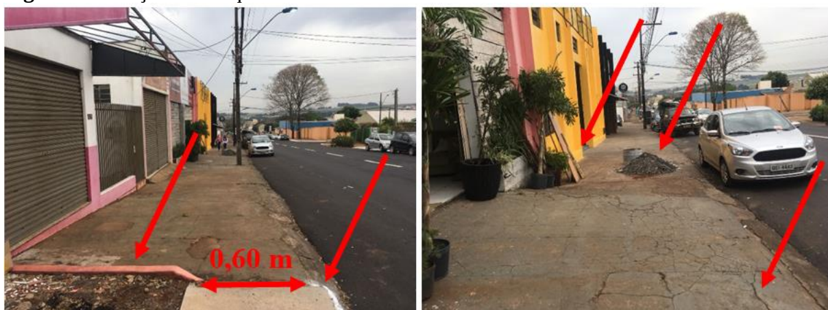
Figura 53: Calçada inadequada no Trecho 2
