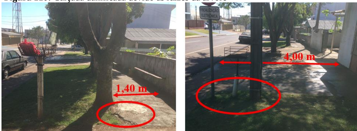
Figura 110: Calçada danificada devido as raízes da árvore
