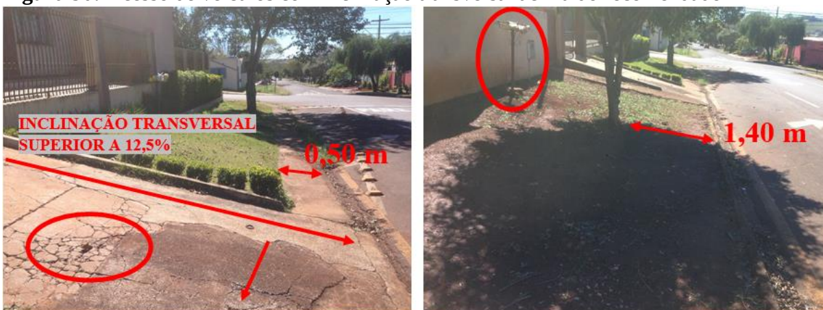
Figura 90: Acesso de veículos com inclinação transversal acima do recomendado
