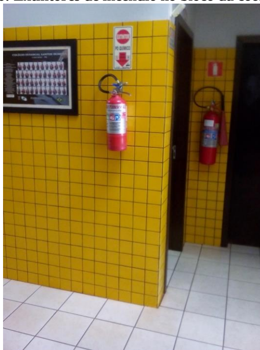
Figura 6: Extintores de incêndio no bloco da coordenação
