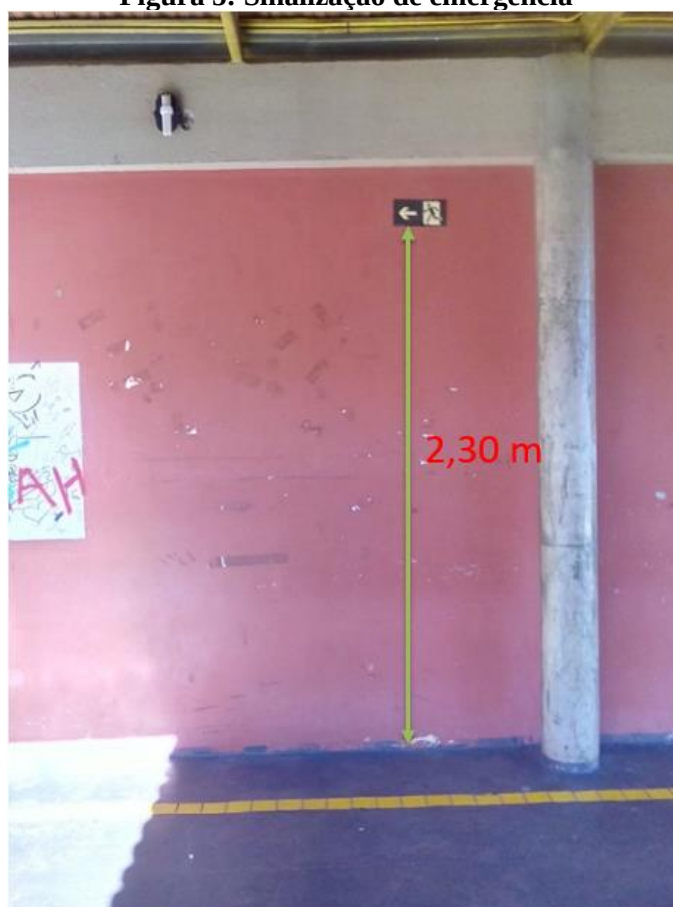
Figura 5: Sinalização de emergência
