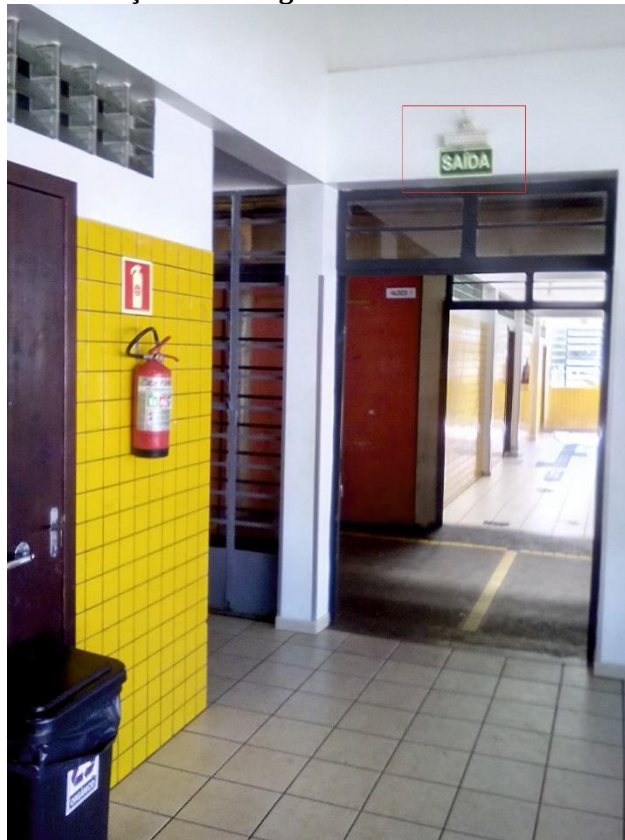
Figura 4: Iluminação de emergência acima da saída de emergência
