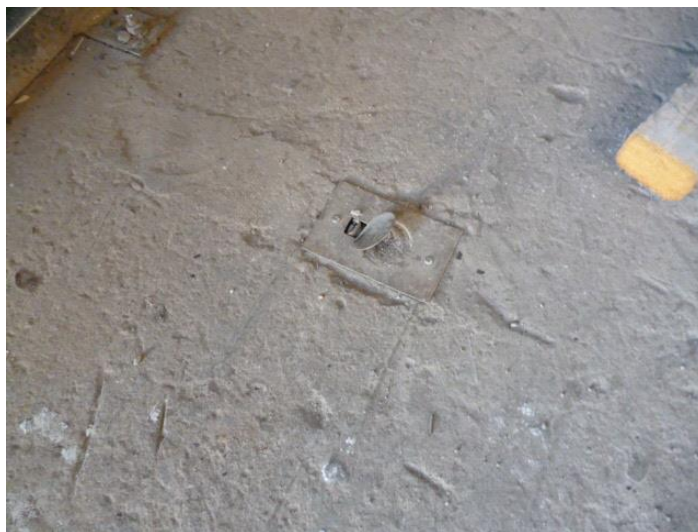
Figura 10: Instalações elétricas inapropriadas
