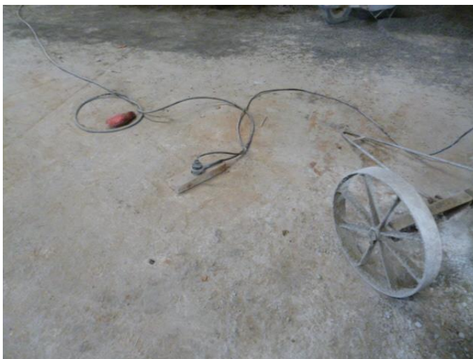
Figura 8: Instalações elétricas inapropriadas.
