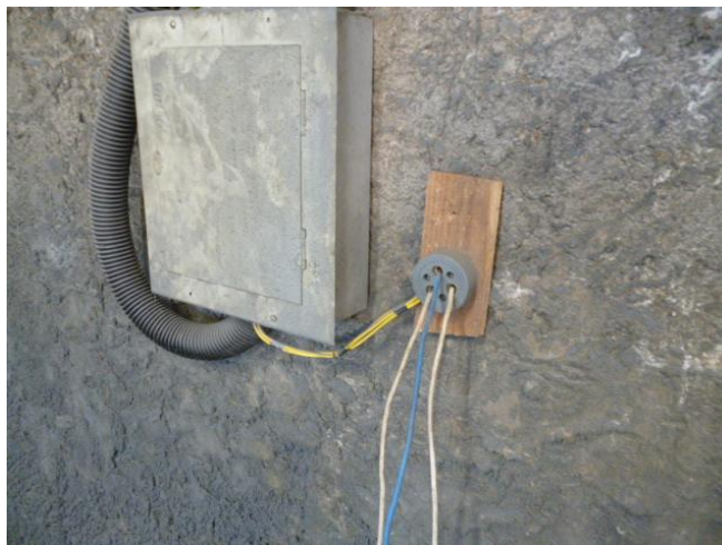
Figura 9: Instalações elétricas inapropriadas
