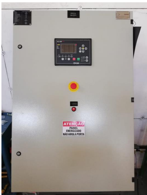
Figura 3.3: Quadro de comando para proteção e sincronização do motor.
