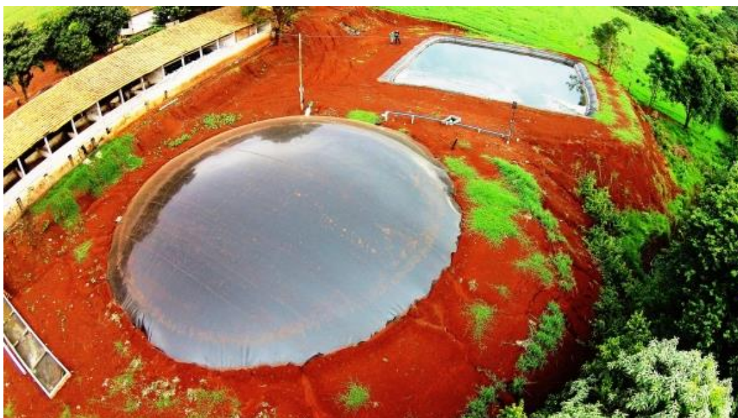
Figura 2.8: Biodigestor instalado com revestimento de lona PVC.
