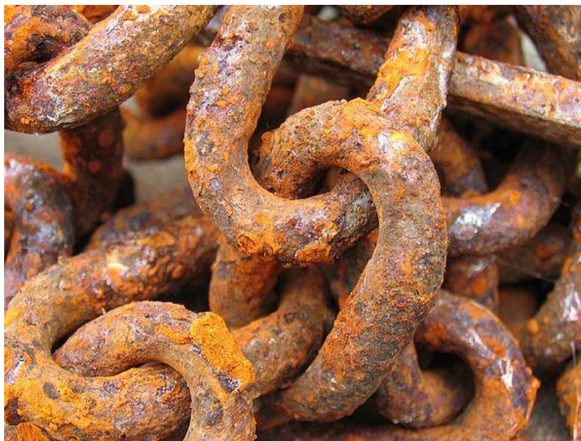
Figura 3: Exemplo de corrosão eletroquímica
