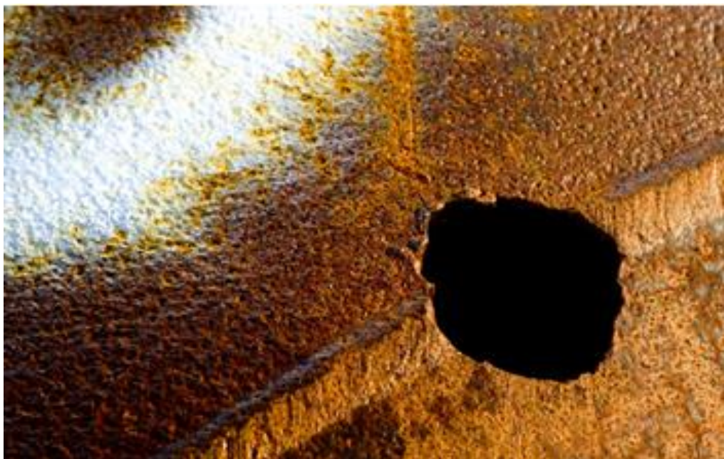
Figura 5: Exemplo de corrosão eletrolítica
