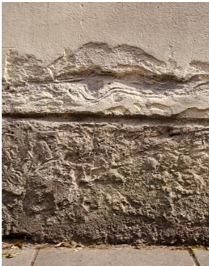
Figura 4: Exemplo de corrosão química
