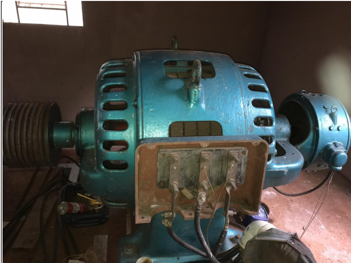
Figura 24: Gerador da casa de máquinas.
