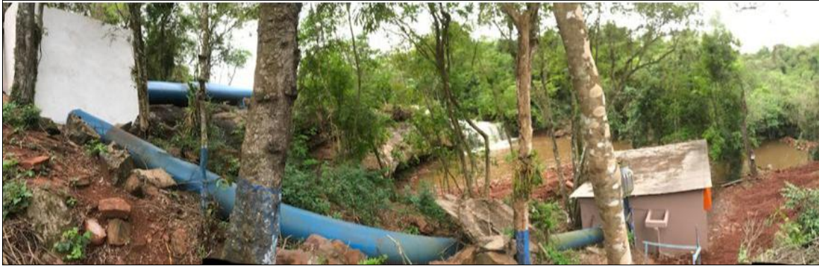
Figura 21: Foto panorâmica da localização da casa de máquinas.
