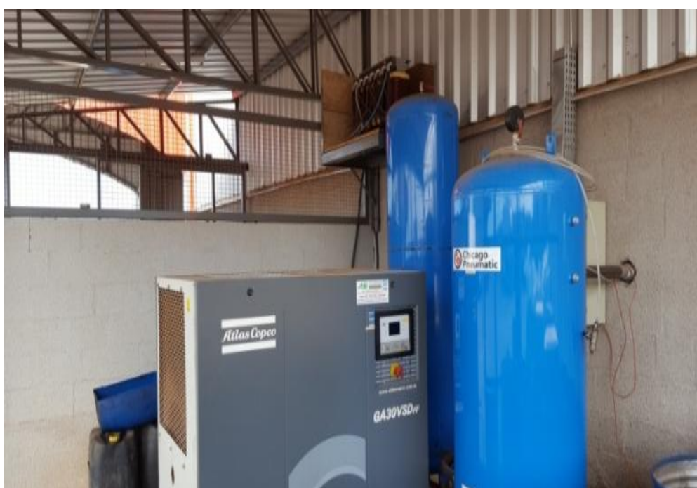
Figura 5: Imagem da sala do compressor.
