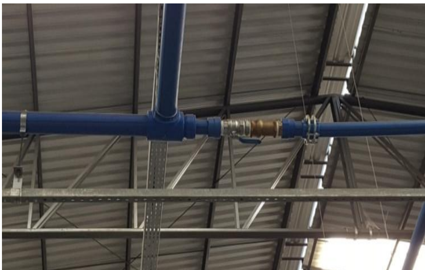
Figura 4: Imagem da válvula de retenção 02.
