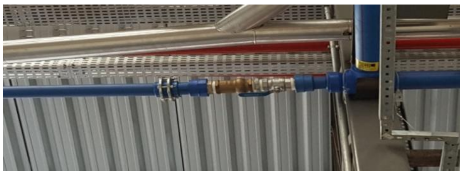
Figura 3: Imagem da válvula de retenção 01.
