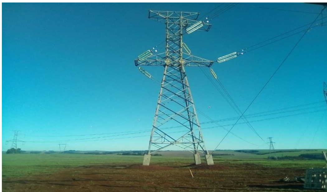
Figura 20 - cadeias de isoladores de ancoragem instaladas em torre de linha de transmissão ainda em processo construtivo.
