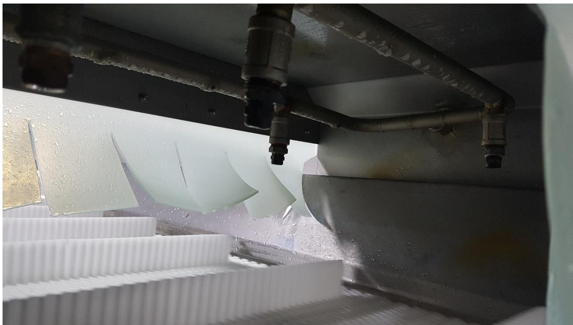
Figura 12 – Bicos já instalados para umidificação.
