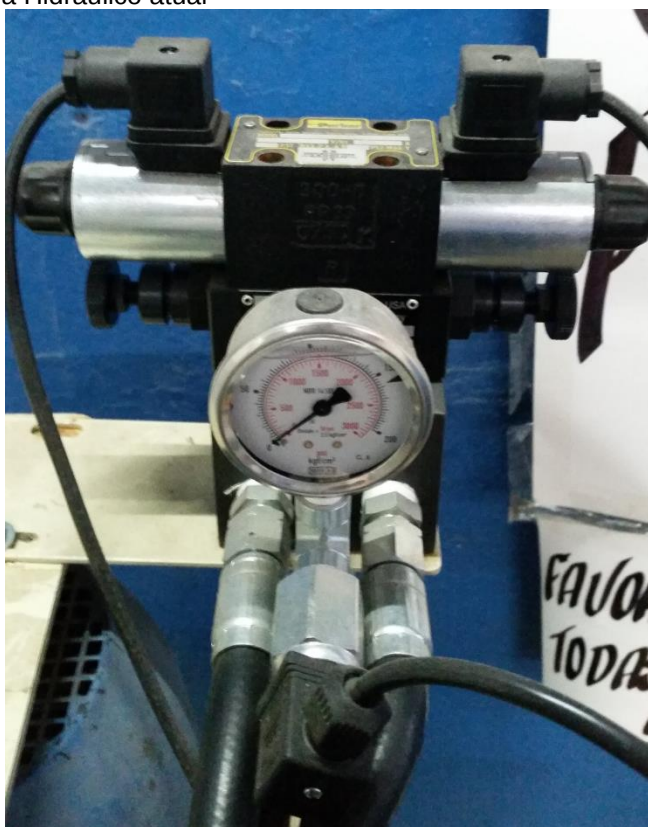
Figura 4.20 Bloco de válvula Hidráulico atual
