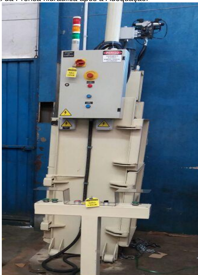
Figura 4.15 Vista Geral da Prensa hidráulica após a Adequação.
