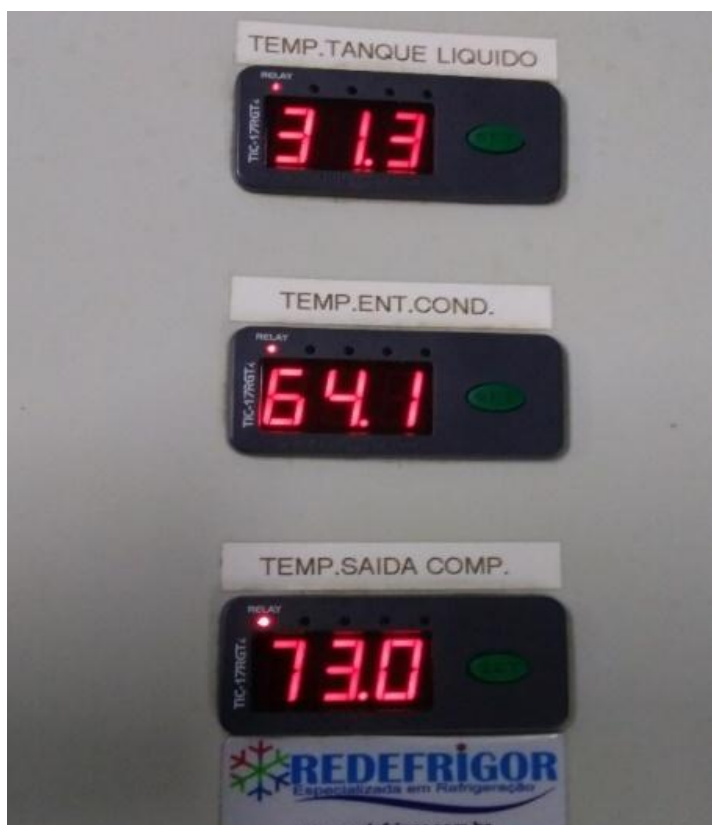
Figura 30 – Interface homem máquina montado com controlador digital de temperatura.
