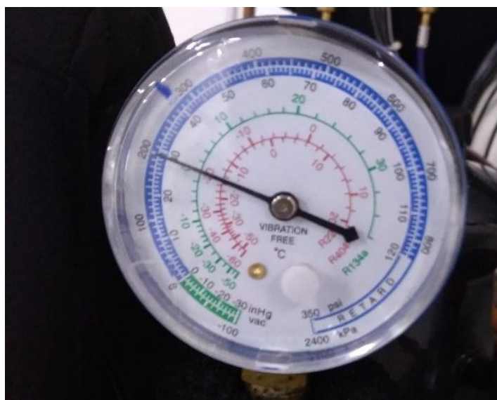
Figura 33 – Pressão de Baixa do sistema de refrigeração.
