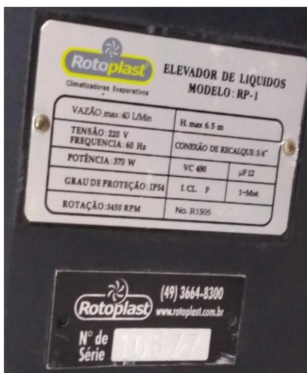
Figura 26 – Identificação da Bomba de água.
