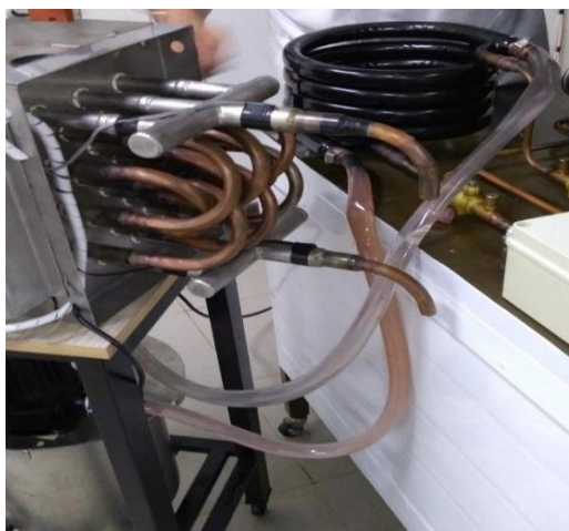
Figura 23 – Trocador de calor refrigerado a água em funcionamento.
