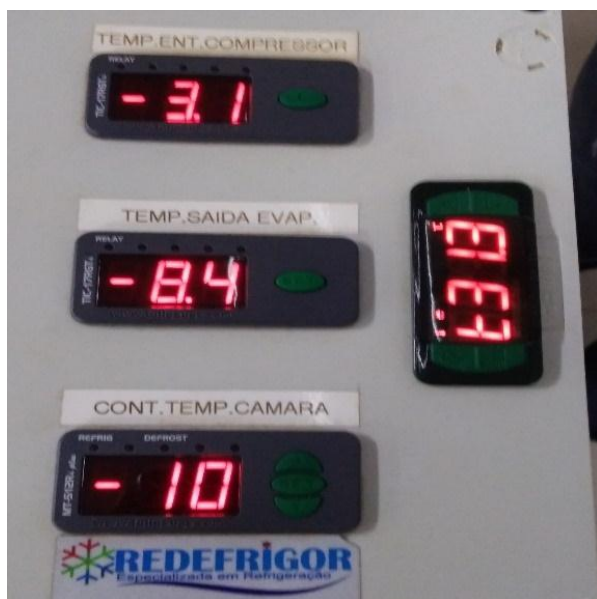
Figura 36 – Interface homem máquina sistema funcionando com o trocador de calor.
