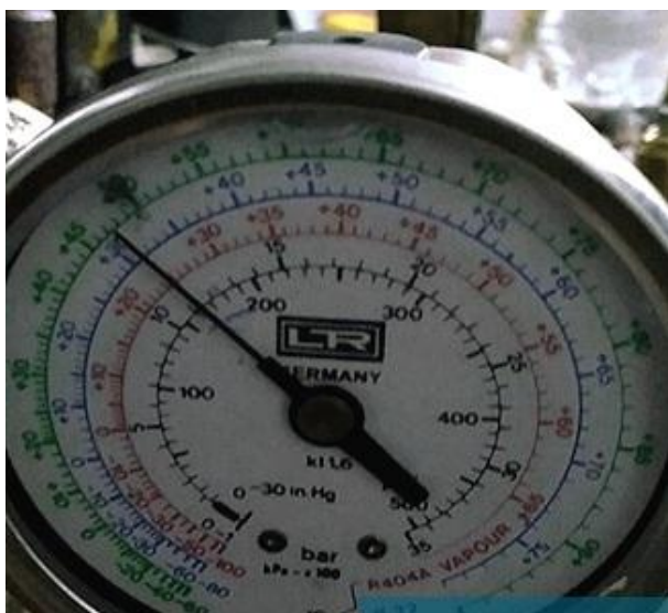
Figura 32 – Pressão de Alta do sistema.
