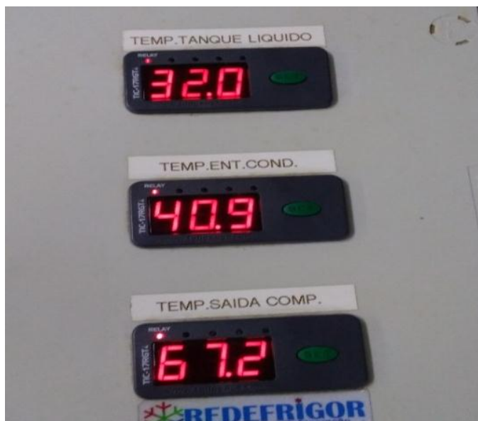
Figura 35 – Interface homem máquina sistema funcionando com o trocador de calor
