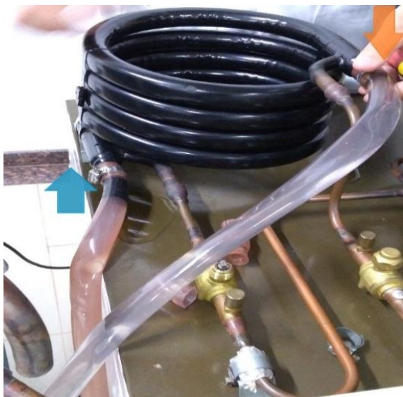
Figura 24 – Imagem das mangueiras instaladas no trocador de calor.
