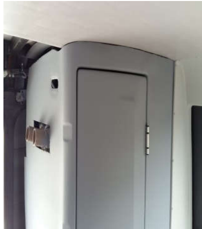
Figura 18: Sanitário sem danos pelo novo processo
