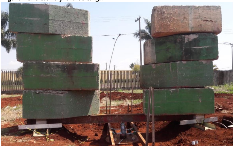
Figura 18: Sistema prova de carga.
