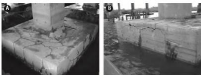
Figura 32 - Bloco de fundação com padrão de fissuração típico de RAA
