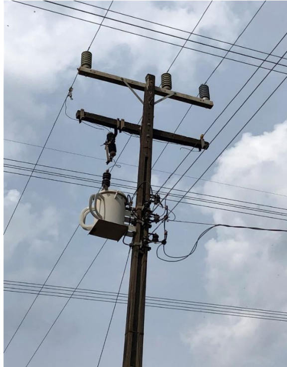
Figura 3.4 – RDR e transformador que atende a propriedade.
